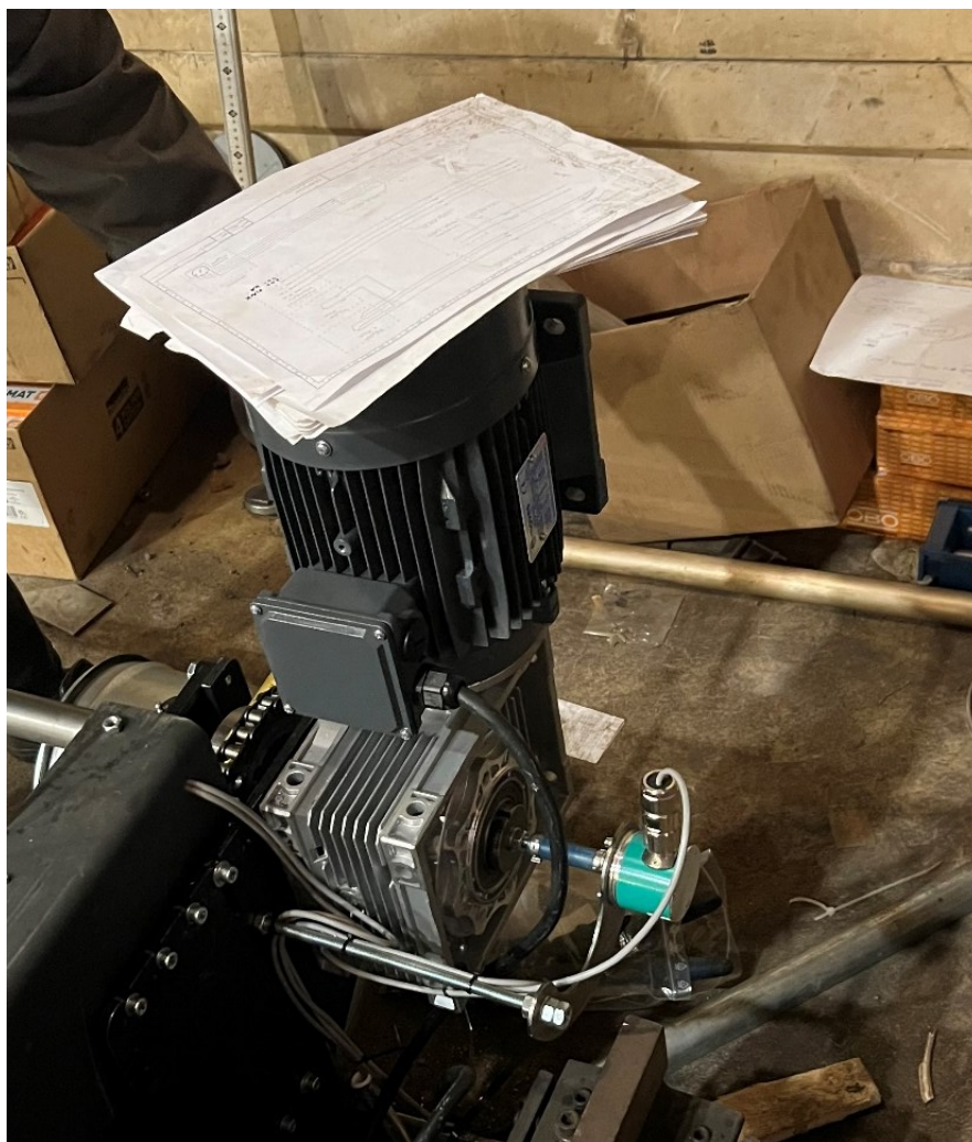
Kuva 43. Imuvaunun moottori, vaihdelaatikko ja pulssianturi
