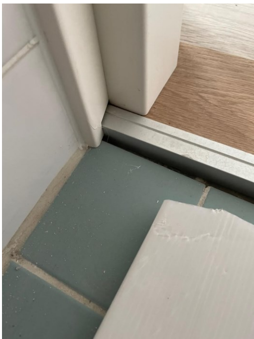
Kuva 9. Kynnyksen ja laatoituksen välistä puuttuu silikoni.
