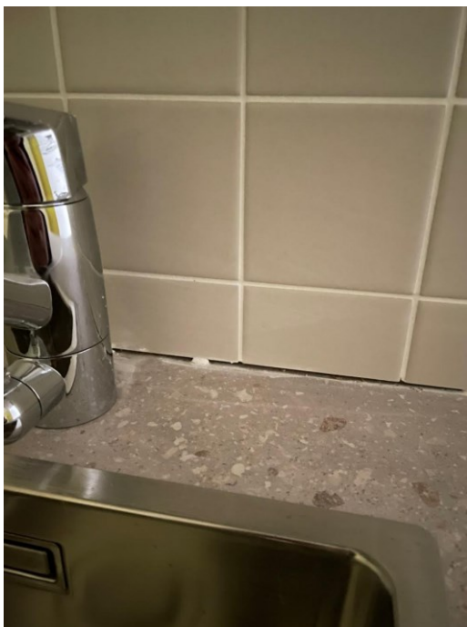
Kuva 10. Keittiötason ja välitilan välinen silikonisauma puuttuu.
