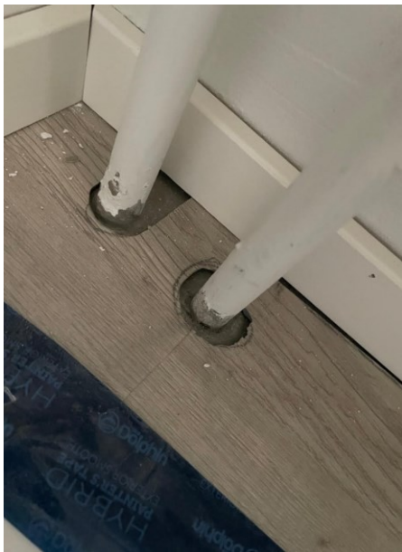
Kuva 11. Patteriputkien ympäryys epäsiisti ja mansetit puuttuvat.
