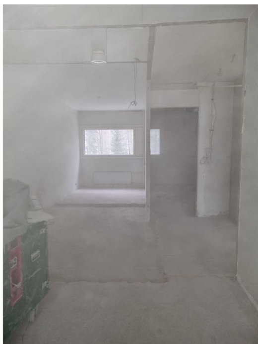
Kuva 25. Huonosti hoidettu pölynhallinta.
