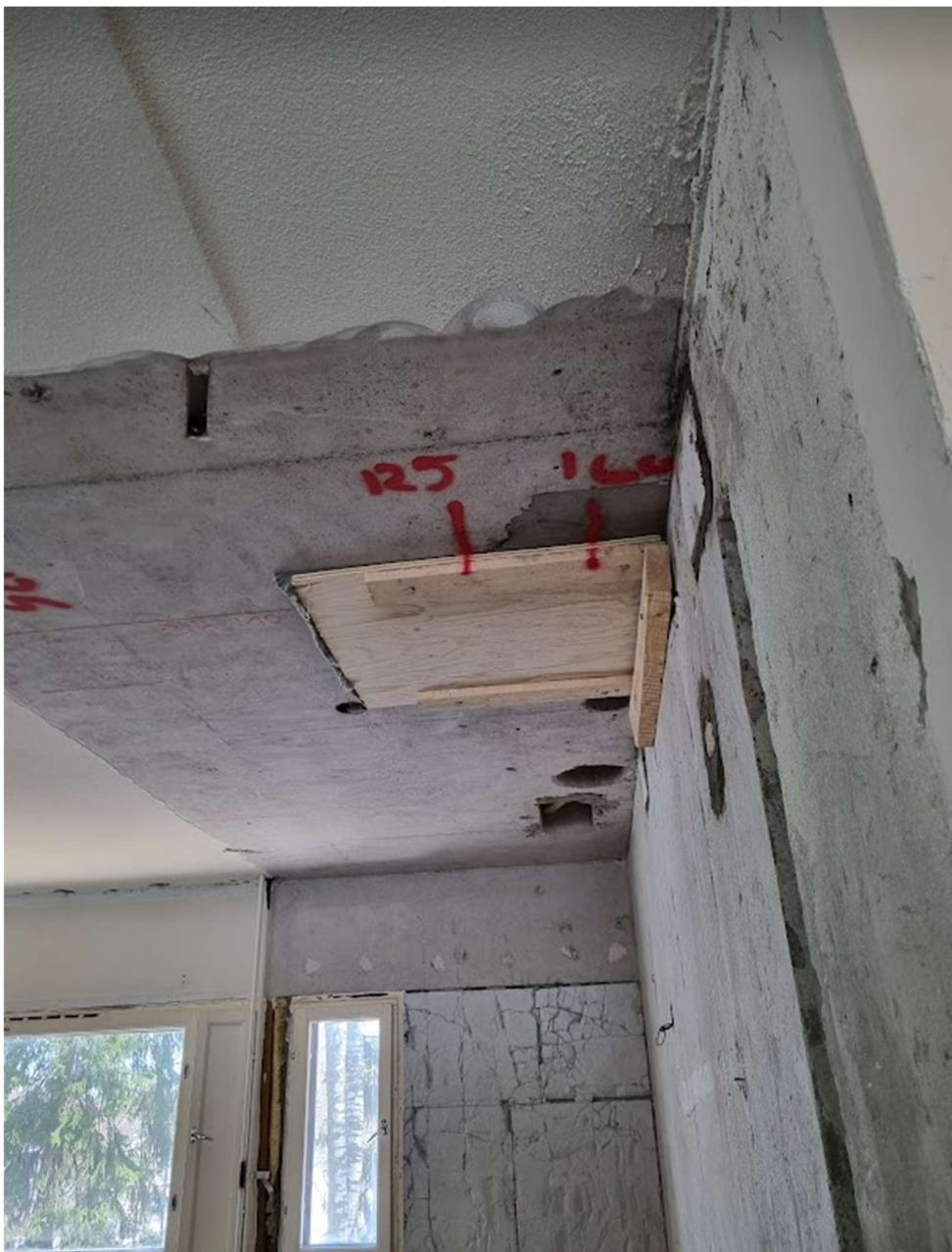
Kuva 27. Alapuolelta suojattu tekniikkahormi.
