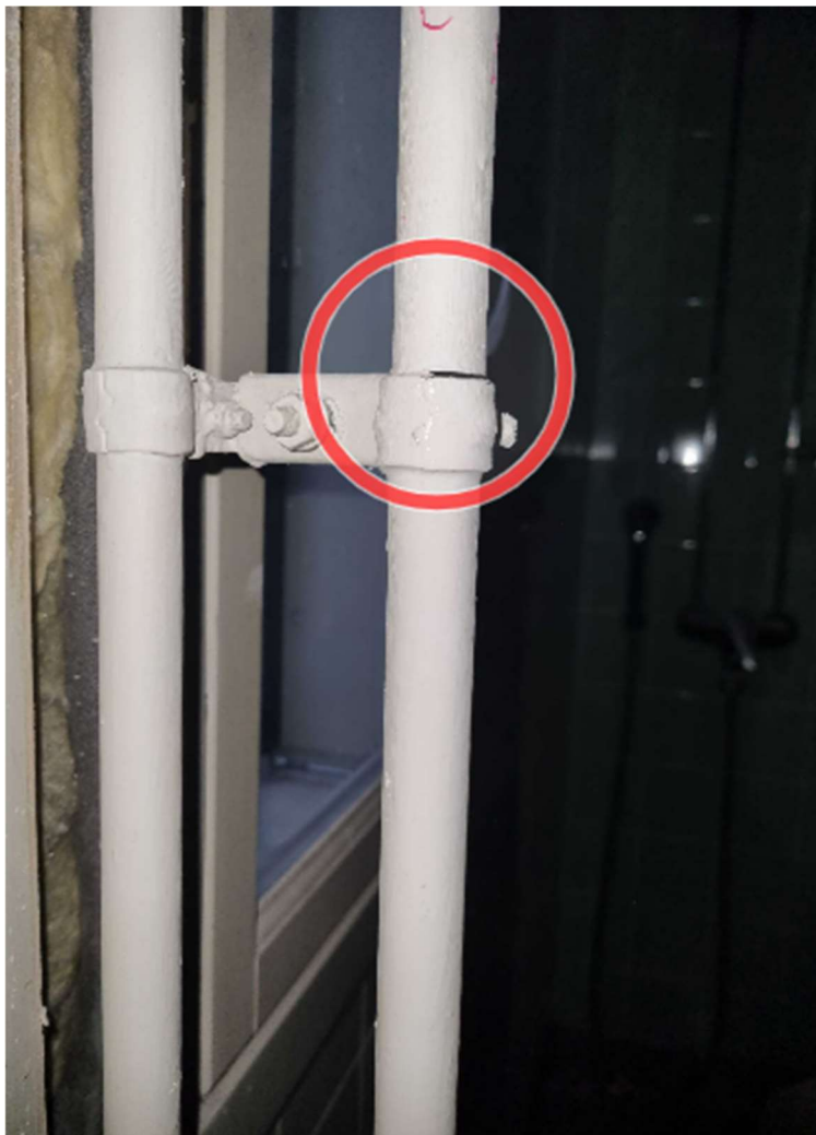
Kuva 30. Toiminnassa oleva lämpölinja.
