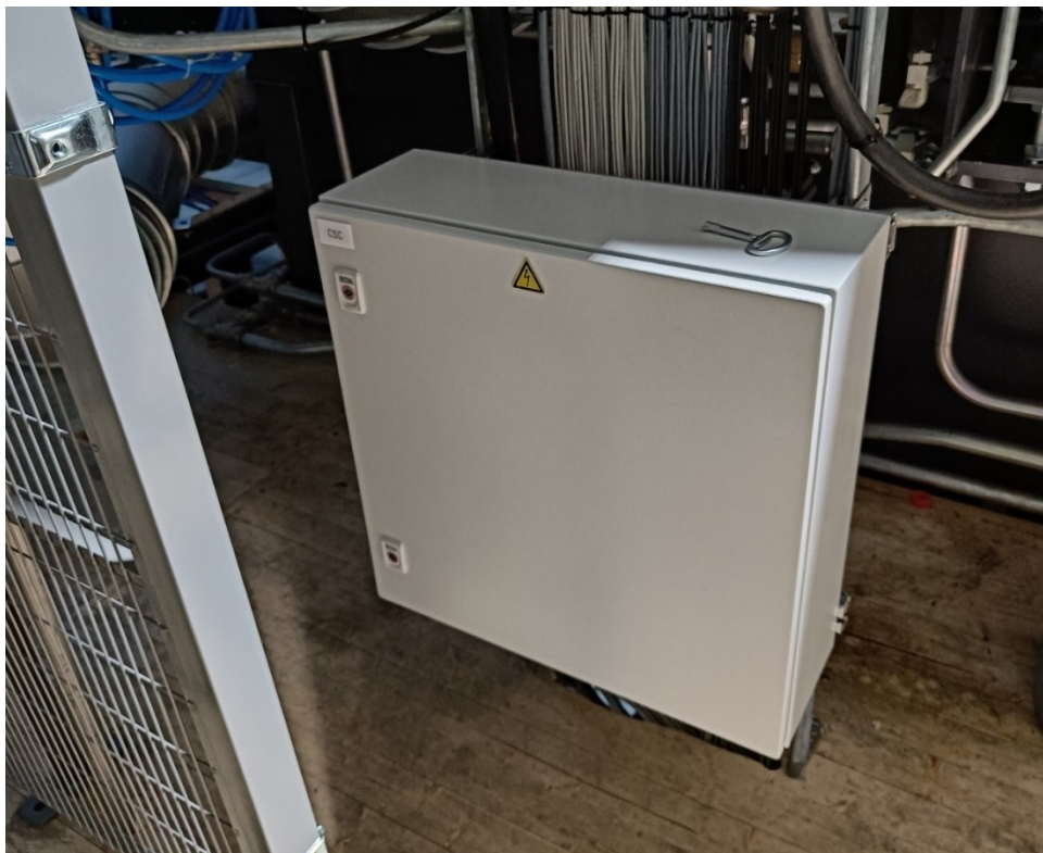
Kuva 19. Kotelo asennettuna ja kytkettynä
