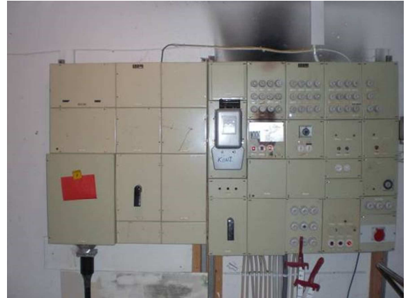
KUVA. 2 Joskus kuumentunut sähköpääkeskus
