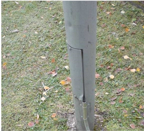
KUVA 5. Pylväsvalaisimesta vedetty kytkentä
