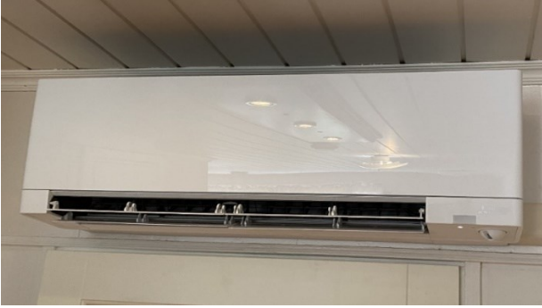
Kuva 13. Kohteen ilmalämpöpumpun sisäyksikkö (Kananoja, 2023).
