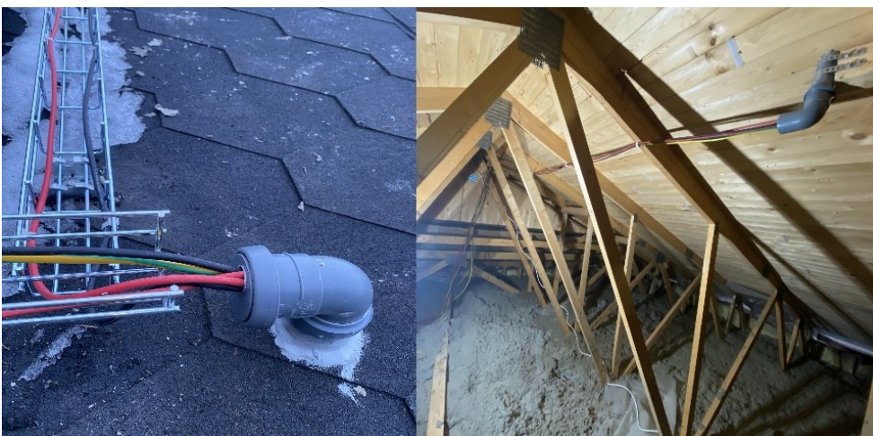
Kuva 30. Aurinkopaneelikaapelien läpivienti katolta välikatolle (Kananoja, 2023).
