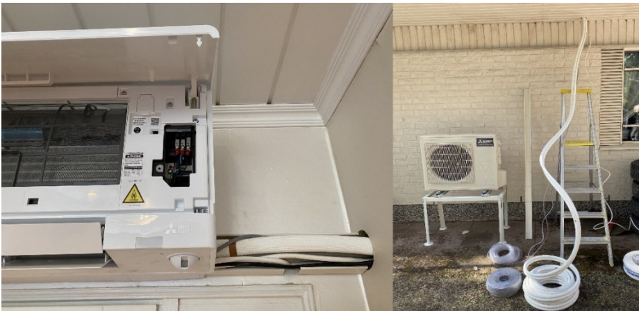
Kuva 21. Kylmäaineputkiston, sähköjohdon ja kondenssivesiputken reititys (Kananoja, 2023).
