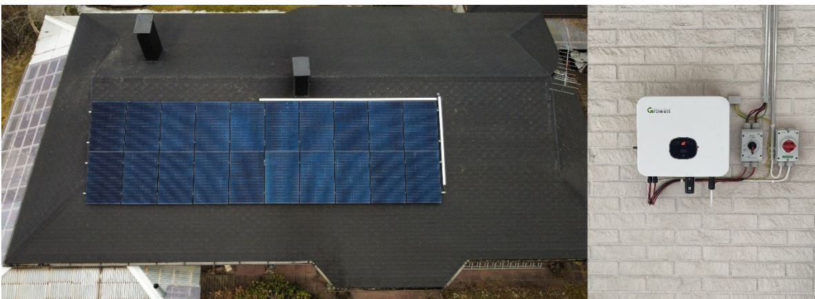
Kuva 32. Valmis aurinkosähkövoimala (Kananoja, 2023).
