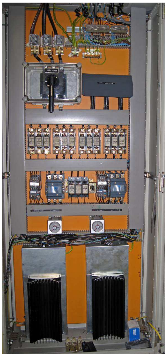
Kuva 9. Suurikokoiset tyristorisäätimet vievät paljon kaappitilaa 525 V:n keskuskaapista.
