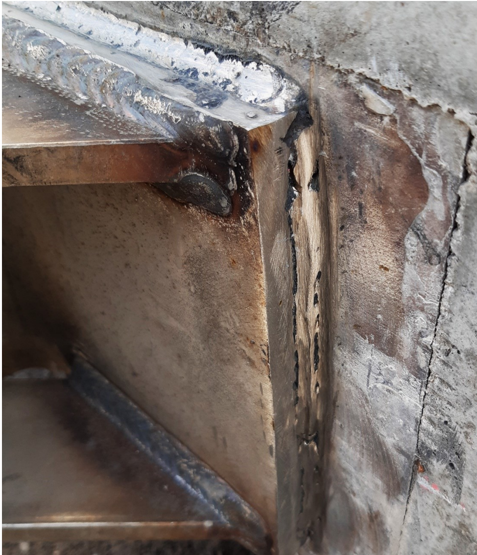
Kuva 18. Elementtitehtaalla hitsattu konsoli, jonka hitsin oli poishiottu.
