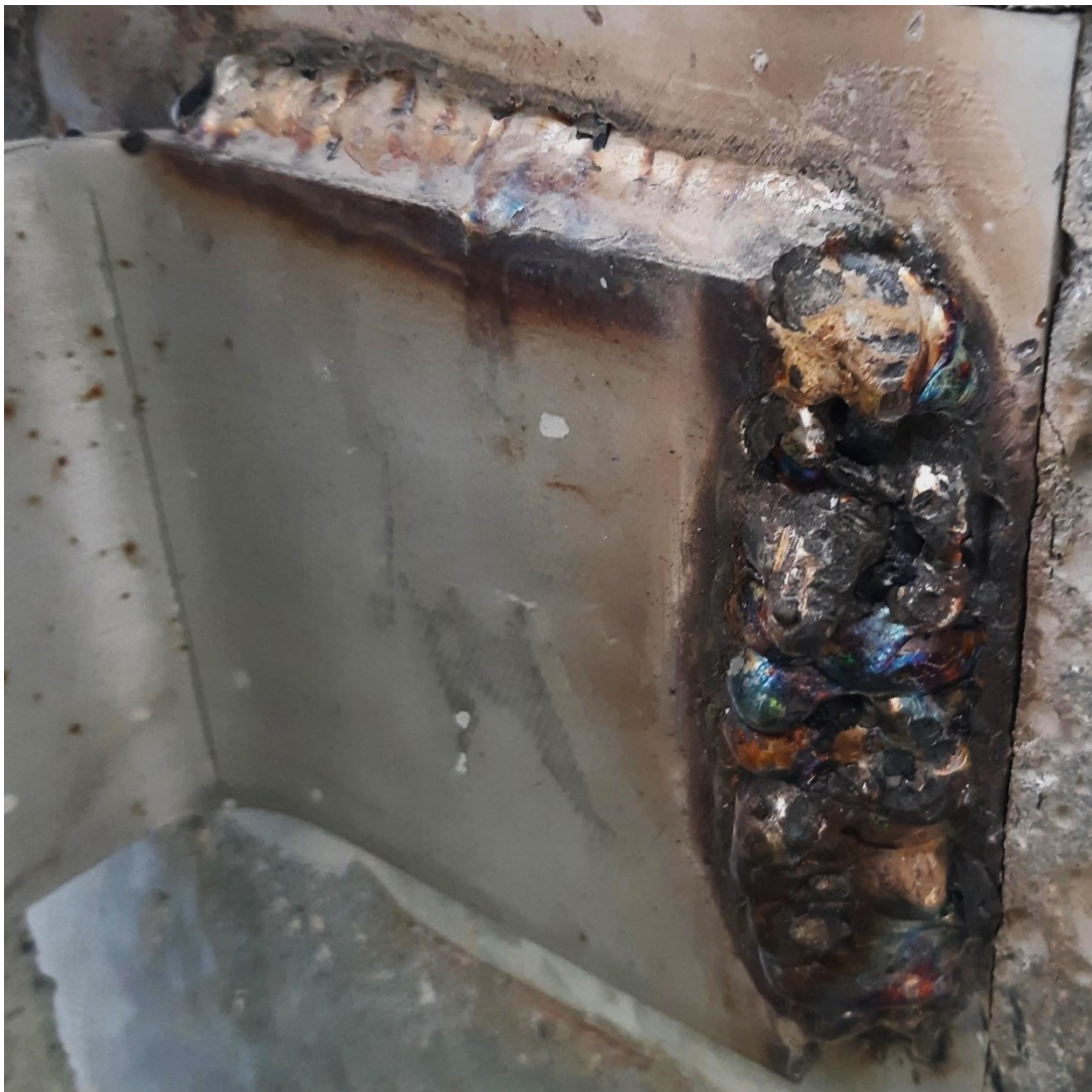
Kuva 10. Virheellisesti hitsattu kulmarauta, jonka hitsissä betonipölyn aiheuttamaa kontaminaatiota.
