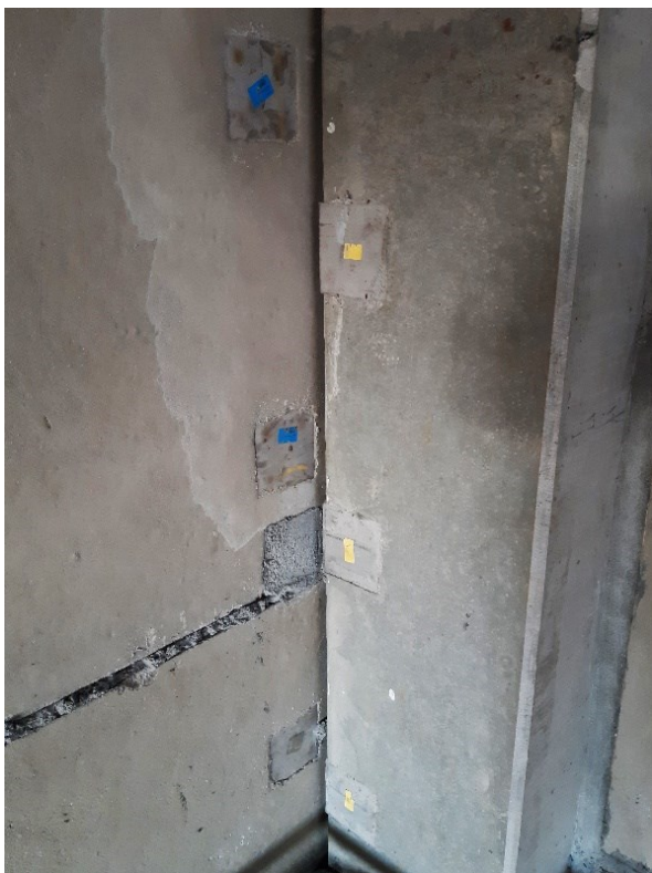
Kuva 32. Useita väärässä paikassa olevia asennuspintoja.
