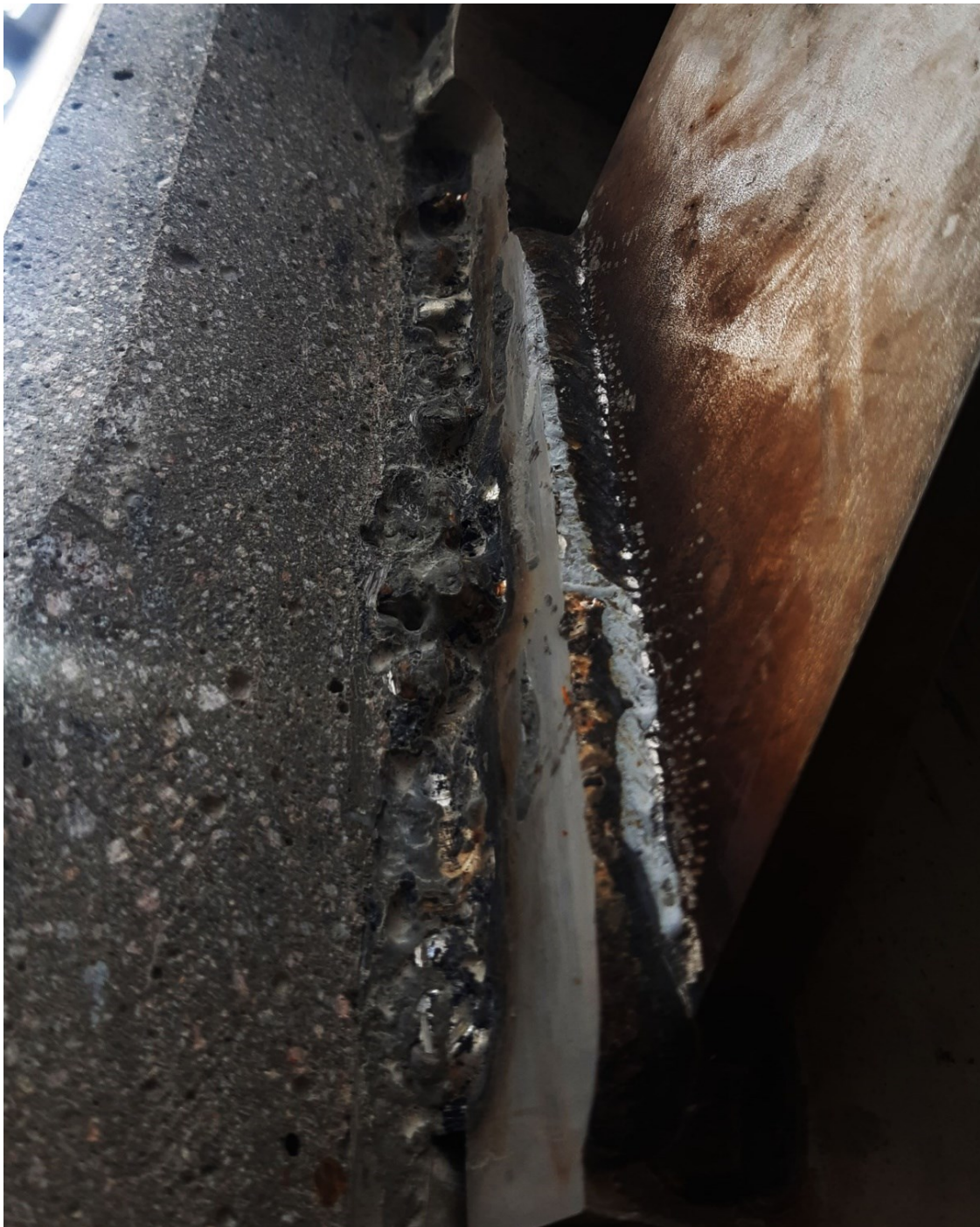
Kuva 24. Virheellisesti betonivalumaksi oletettu hitsi.
