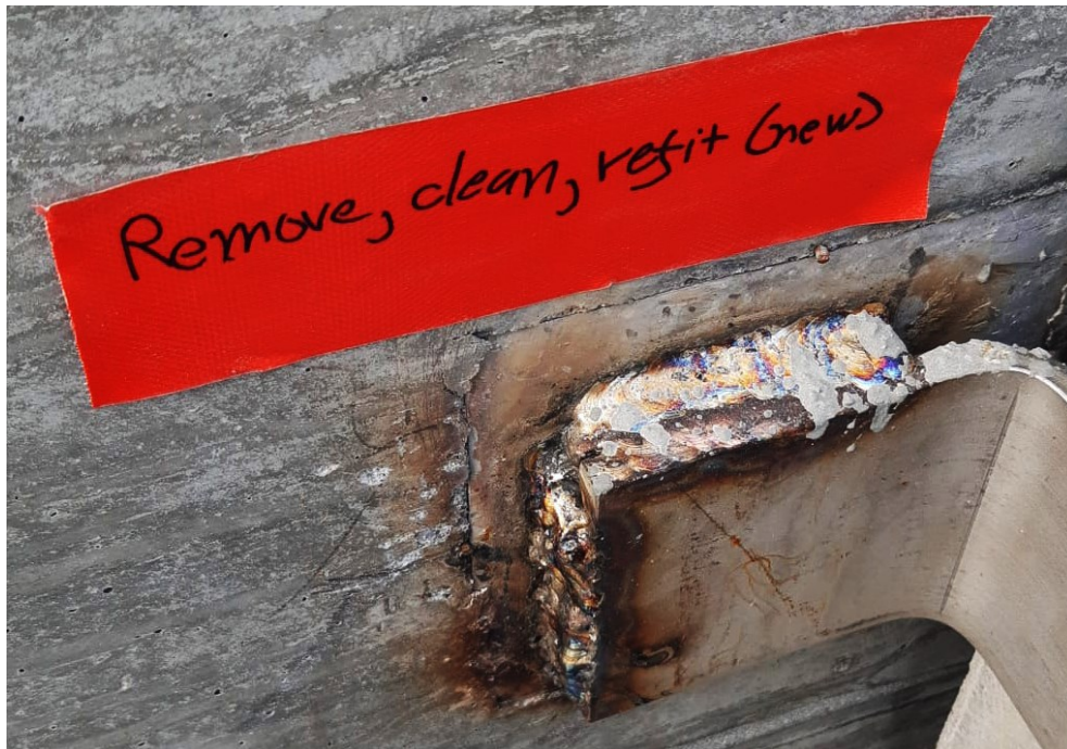
Kuva 1. Korjattavan kohteen merkintä.
