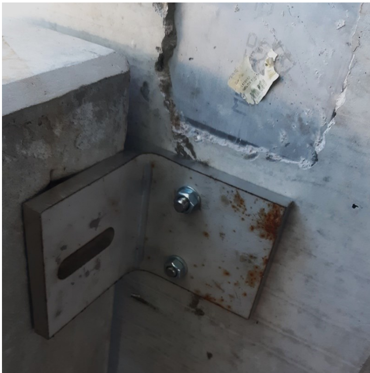
Kuva 31. Väärässä paikassa oleva asennuspinta.
