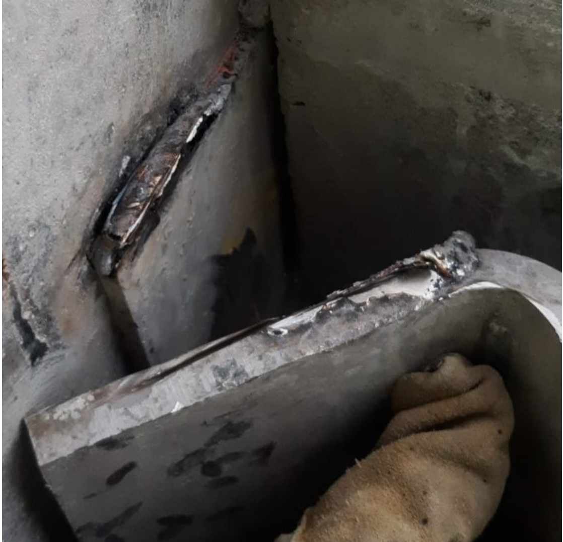
Kuva 13. Asennuspinta pilarin tason ulkopuolella, sovitusvirhe kulmaraudassa ja riittämätön hitsi.
