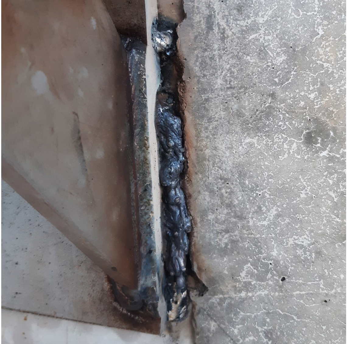
Kuva 16. Konsoli, jossa hitsausvirheitä ja ahdas asennustila.
