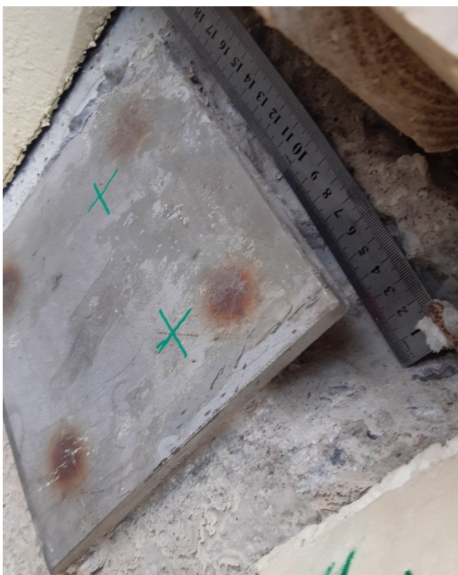
Kuva 34. Vajaa betonivalu asennuspinnan takana.
