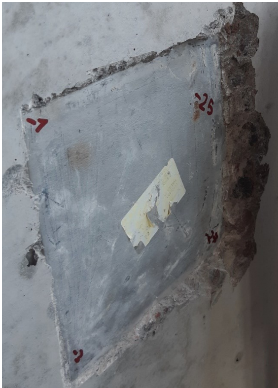
Kuva 28. Huonossa asennossa oleva asennuspinta.
