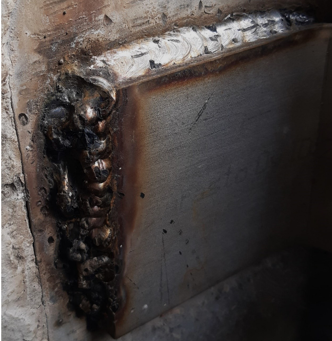
Kuva 11. Virheellisesti hitsattu kulmarauta, jossa on kuonasulkeumia.
