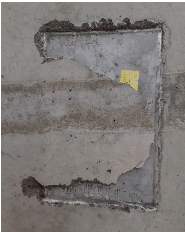
Kuva 29. Betonin alle piiloon jäänyt asennuspinta.
