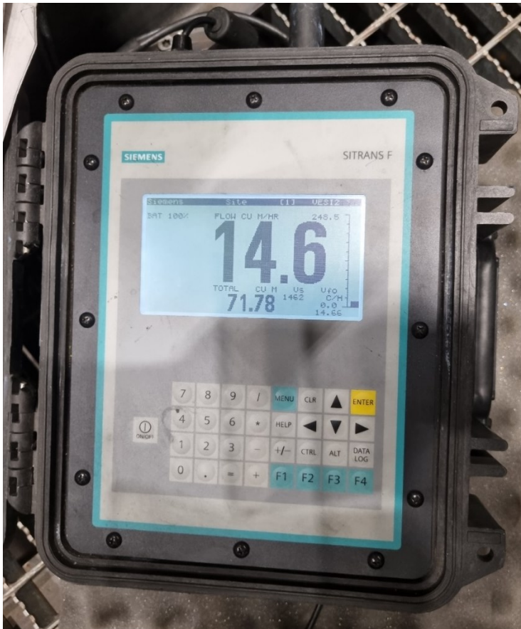
Kuva 14. Mittauksissa käytettävä Siemens Sitrans F -mittalaite.
