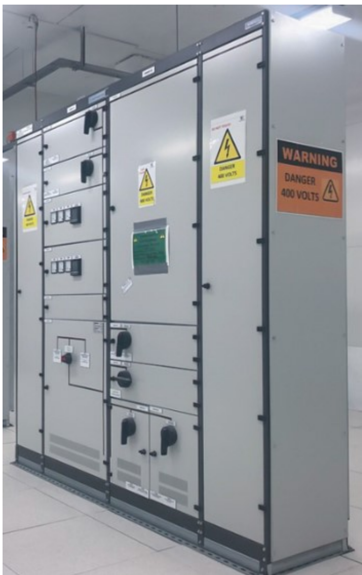
Kuva 3. Esimerkki kennokeskuksesta (Norelco Oy, 2022)
