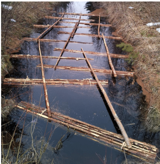
Kuva 3. Kuvassa on nippumallinen uppopuupuhdistamo, joka on kiinnitetty paikalleen tukirangoilla. Kuva Esko Keskinen (PuuMaVesi-hanke)
