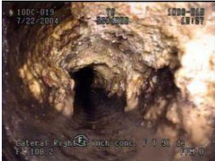
Kuva 1 Rasva jätevesiviemärissä (City of Ashland n.d.)
