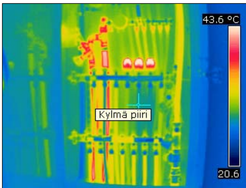
Kuvio 15: Lattialämmityksen jakotukki, jossa on kolme viileää piiriä (2., 5. ja 6. vasemmalta)
