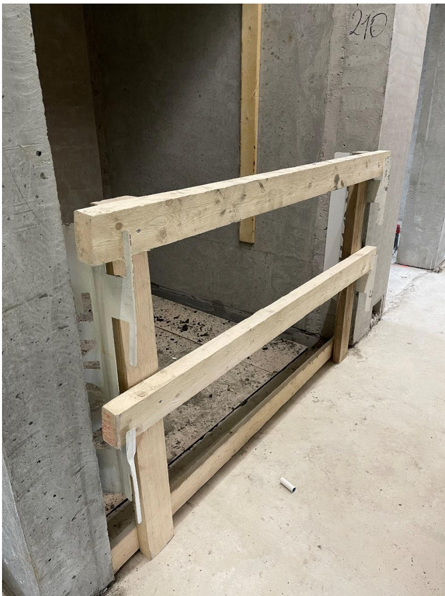
Kuva 11. Hissikuilun putoamissuojaus (Aleksi Renko)
