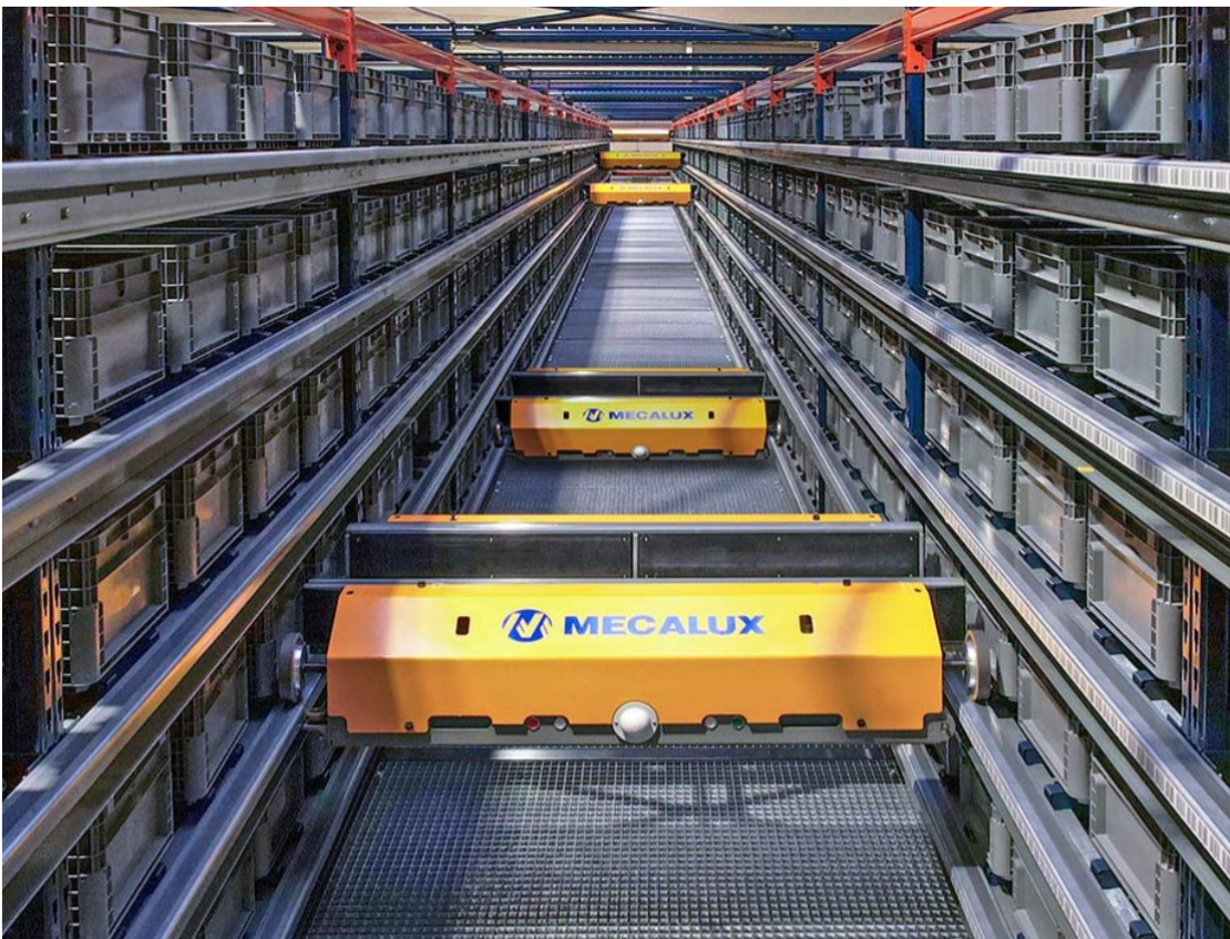
Kuvio 5. Mecalux yrityksen shuttle-automatavarasto käytävän sisältä (Shuttle system n.d.)
