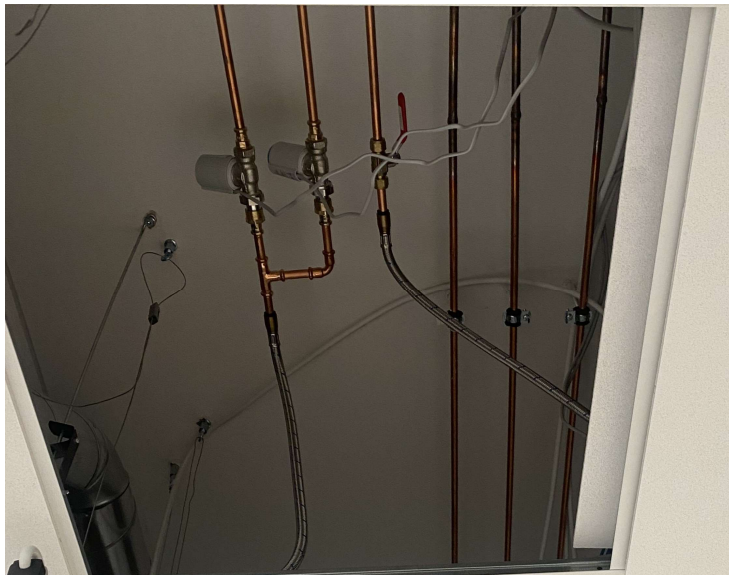
Kuva 6. Lämmitys- ja jäähdytysventtiilien toimilaitteet
