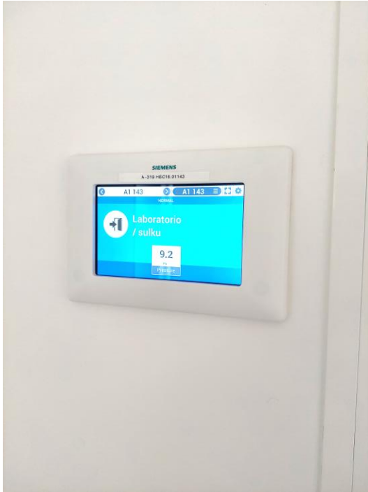
KUVA 8. OYS 2030, laboratorion sulkutilan oviautomaatio (kuva: Tii Hautajärvi)
