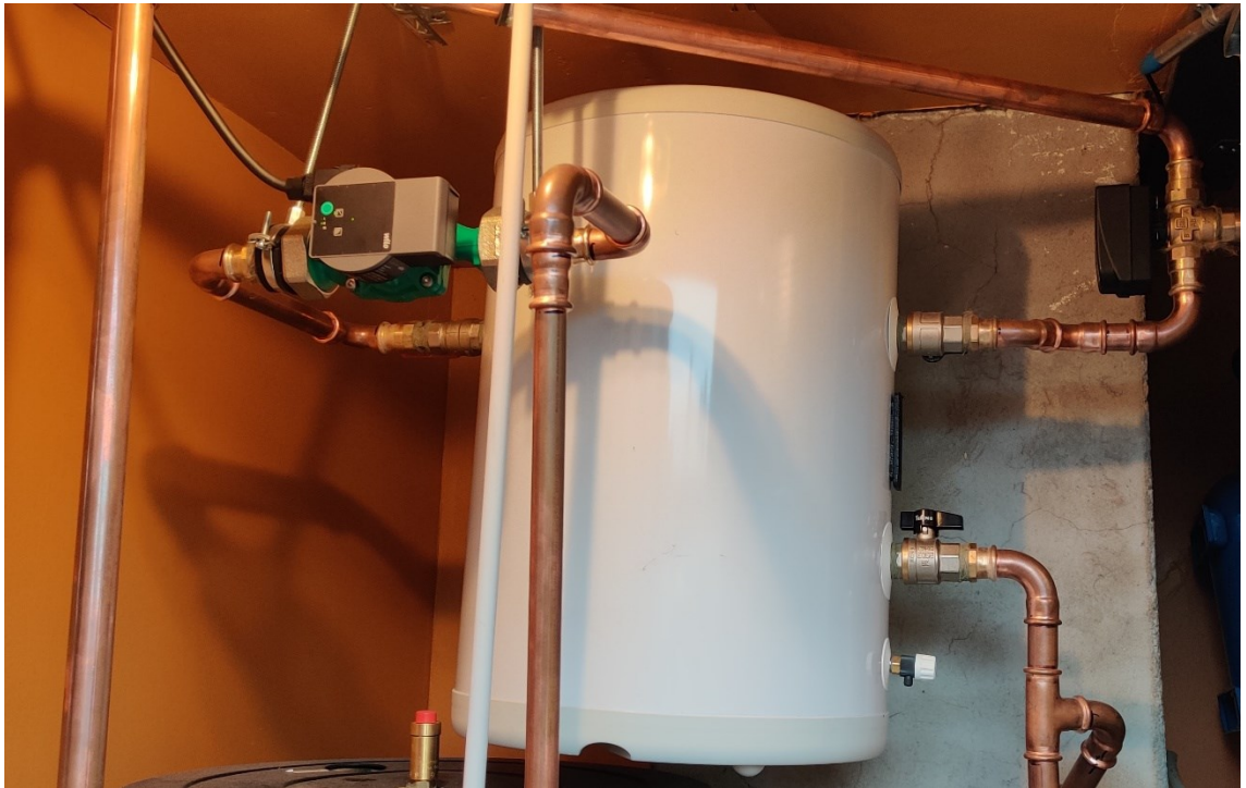
Kuva 7. Patteriverkoston puskurivaraaja 50 l, pumppu ja kolmitieventtiili.
