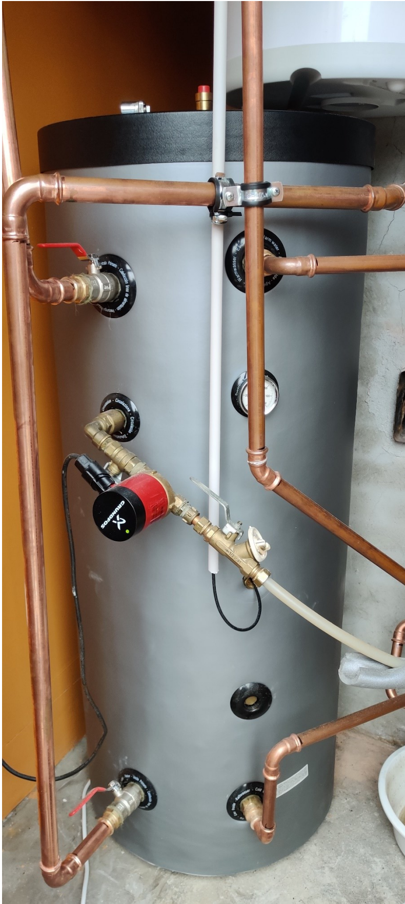
Kuva 6. Käyttövesivaraaja Ambista 200 l asennettuna.
