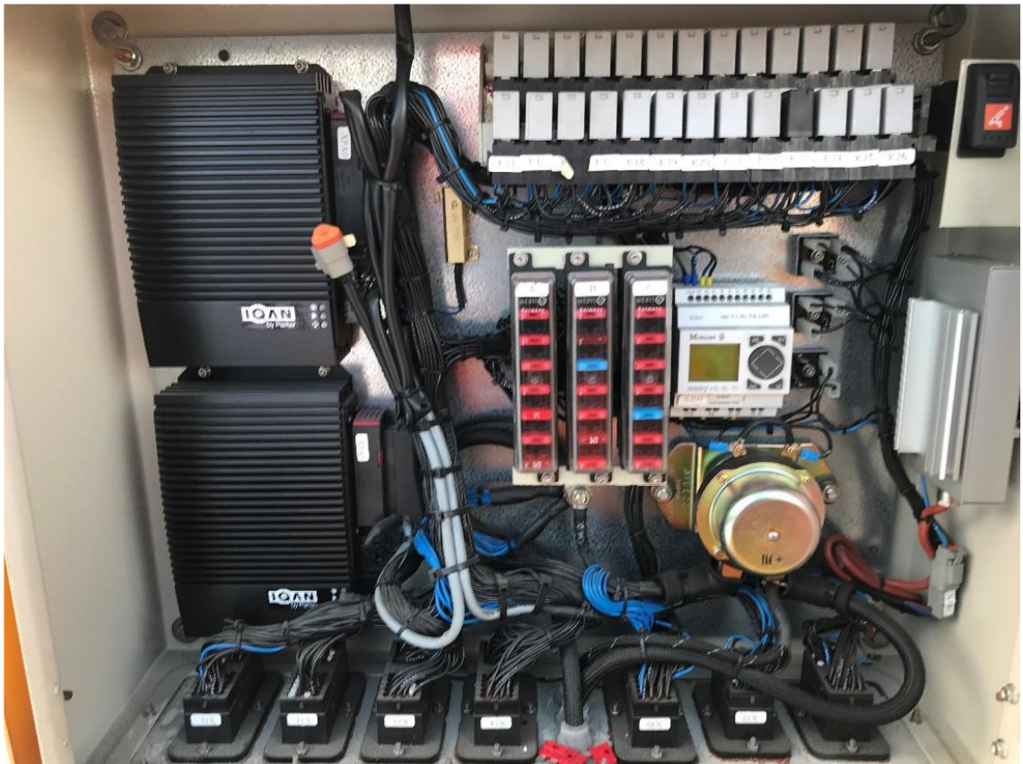
Kuva 13. Sähkökeskus. (Kuva: Juho Seppänen)
