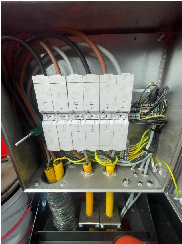
Kuva 9. Sähkökeskus, sähkömoottorilla varustetussa koneessa (Kuva: Juho Seppänen)
