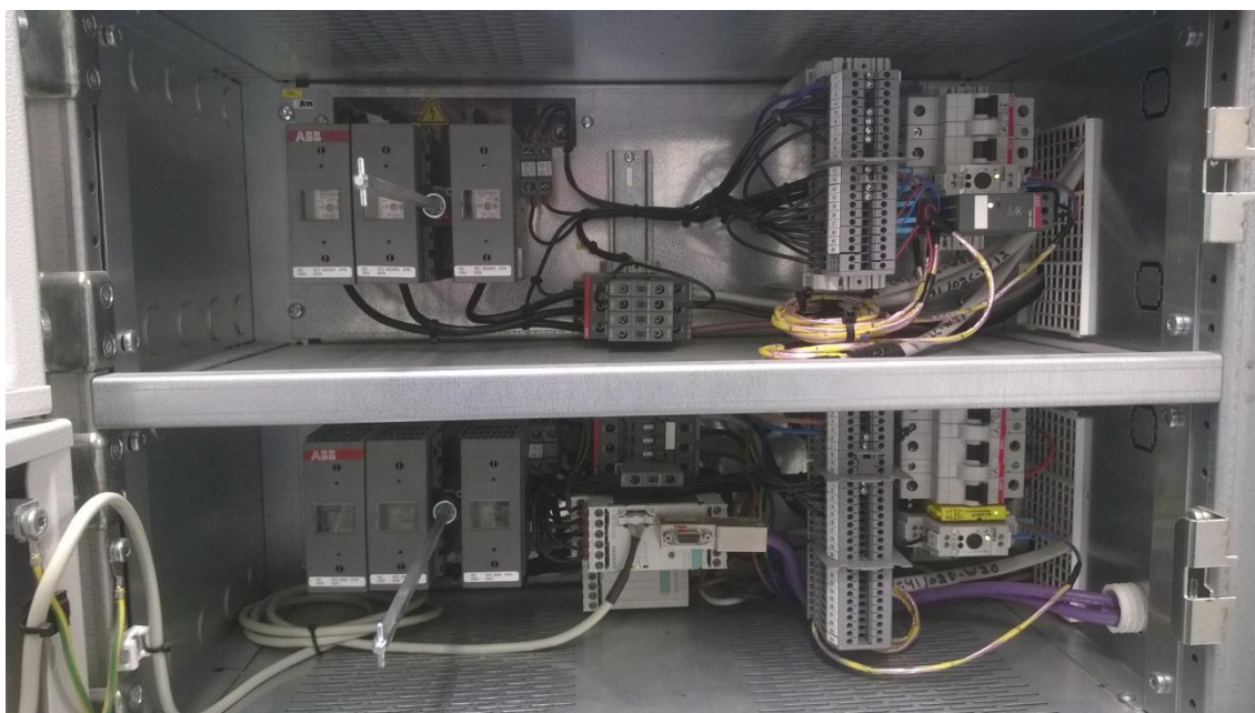
Kuva 16. Ylhäällä kytkinvarokkeella ja etukontaktorilla varustettu taajuusmuuttajalähtö. Alhaalla kytkinvarokkeella varustettu Simocode-ohjattu suora kontaktorilähtö.
