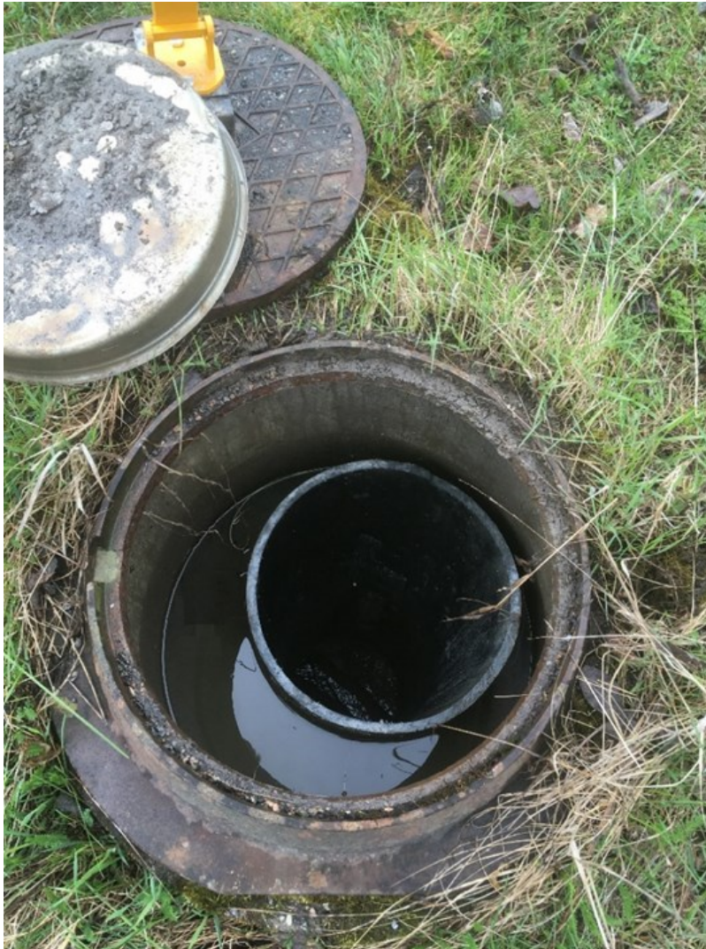
Kuva 12 Vettä saneeratun kaivon rakenteiden välissä.
