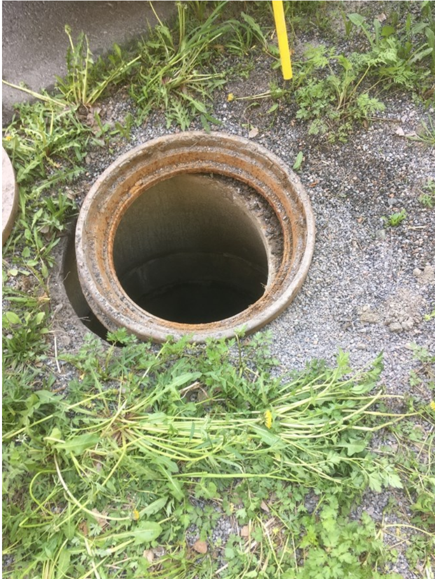
Kuva 16 Paikaltaan siirtynyt kaivon kehys.
