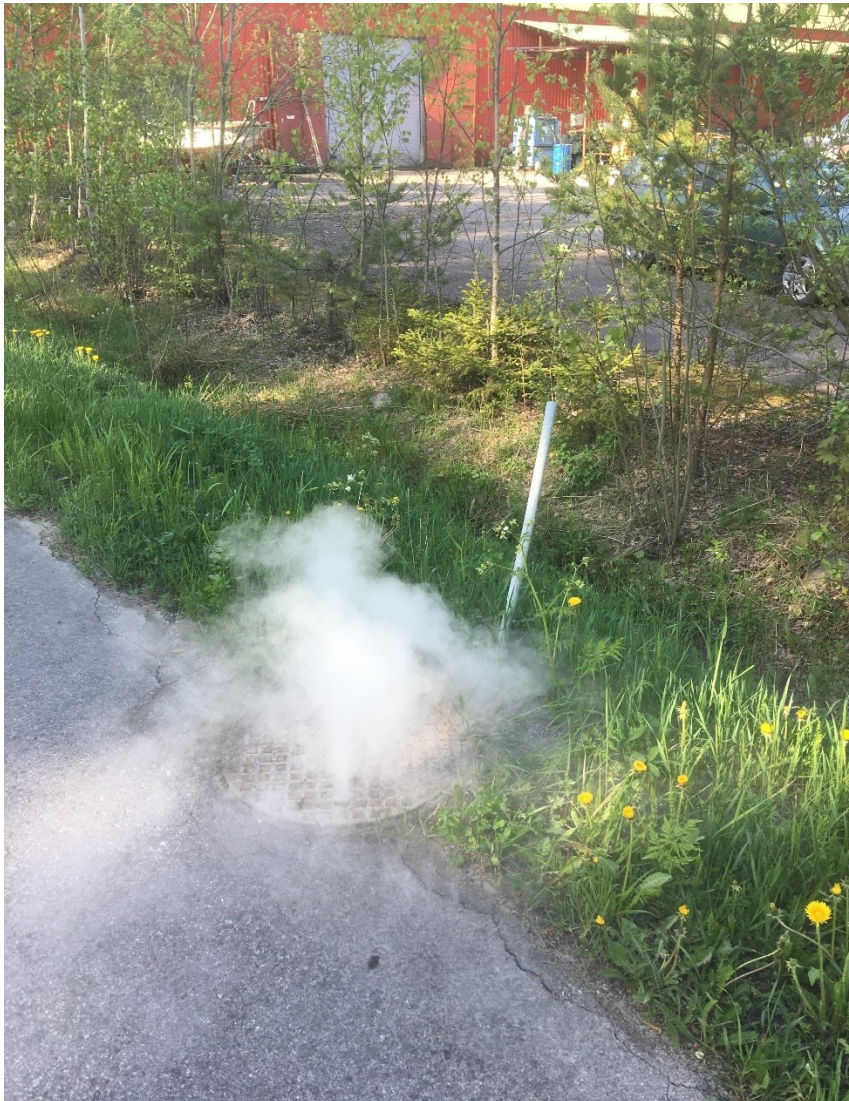
Kuva 13 Tarkastuskaivon kannen väleistä nousee savua.
