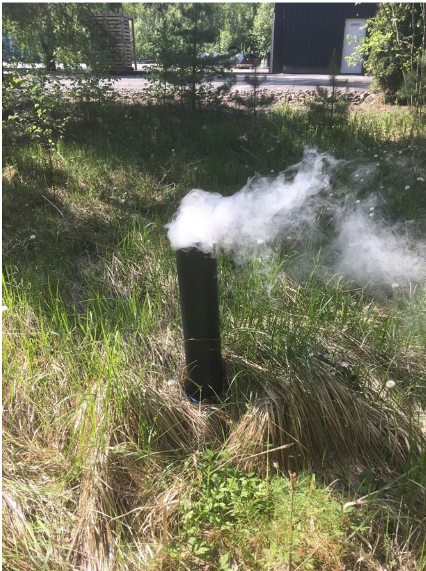
Kuva 15 Tarkastusputki ilman kantta.
