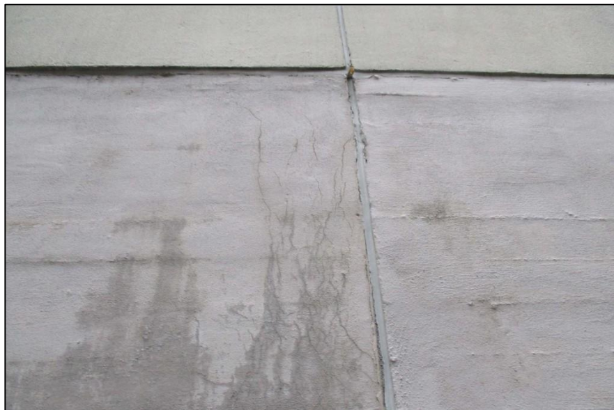
Kuva 3. Betonin pakkasrapautuminen julkisivussa. [7.]
