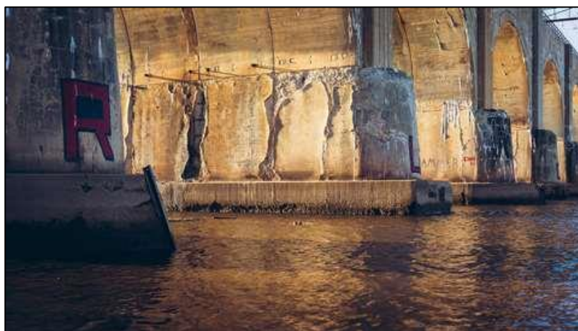
Kuva 17. Sillan betonipilareiden teräsvahvikkeet ovat altistuneet korroosiolle. [23.]
