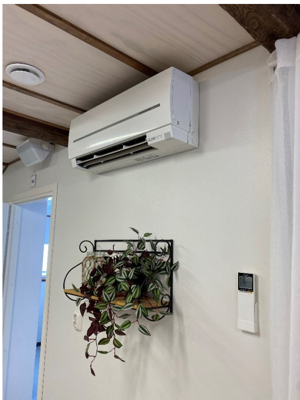
KUVA 35. Ilmalämpöpumpun yleisilme. (Huusko 2023)
