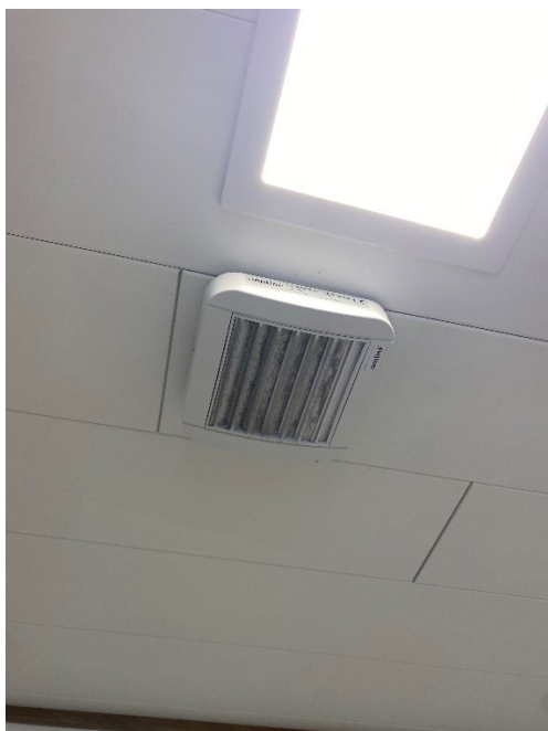
KUVA 31. Likainen poistoilma venttiili (Huusko 2023)
