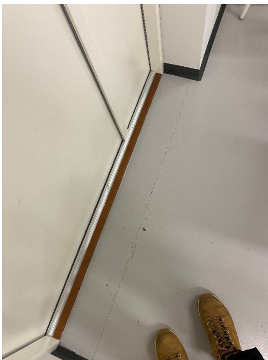
KUVA 14. Lattian halkeama juhlasalista latobaariin johtavalla ovella (Huusko 2023)
