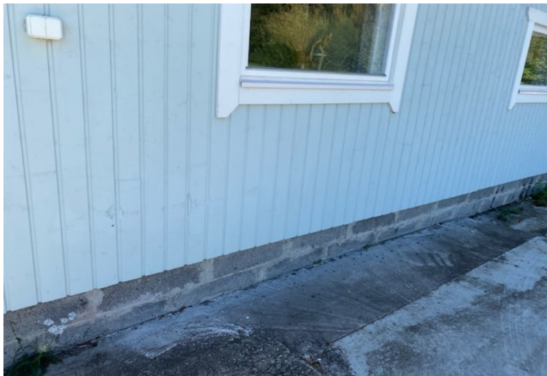
KUVA 8. Harkkosokkelista puuttuu rappaus. (Huusko 2023)
