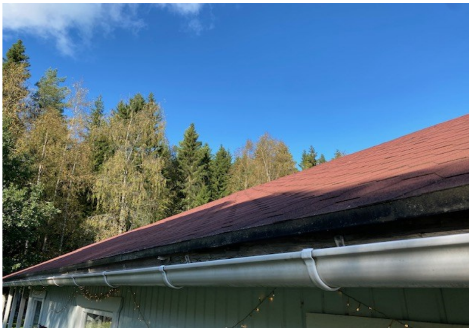
KUVA 23. Räystäiden aluslaudoituksessa maalin rappeutumista. (Huusko 2023)
