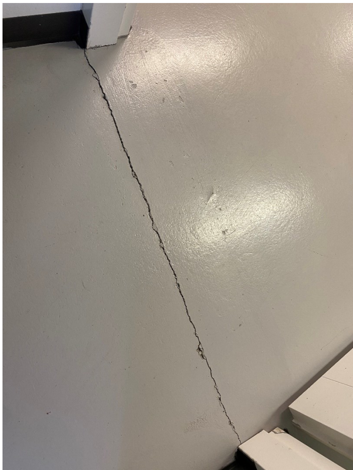
KUVA 13. Lattian halkeama juhlasalista wc tiloihin mennessä (Huusko 2023)
