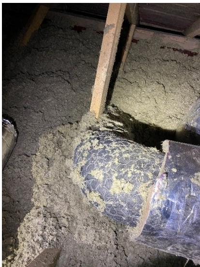
KUVA 17. Eristys jäänyt kesken (Huusko 2023)
