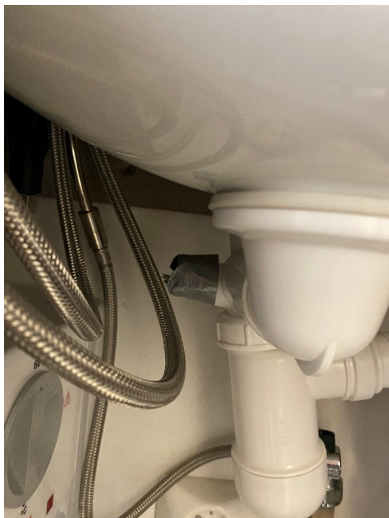
KUVA 30. Teipattu pesukoneen poisto putken paikka (Huusko 2023)
