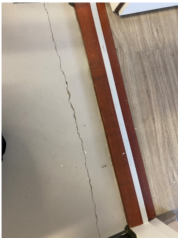
KUVA 12. Lattian halkeama eteiseen johtavan oven edustalla. (Huusko 2023)
