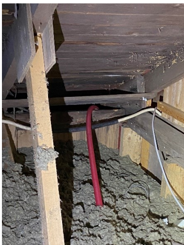
Kuva 18. Vesiputki kulkee yläpohjassa (Huusko 2023)
