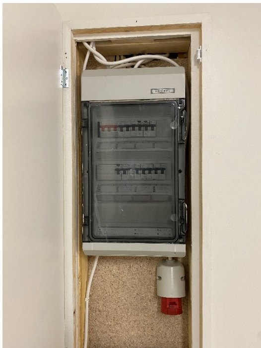
KUVA 36. Uusittu sähkökeskus (Huusko 2023)
