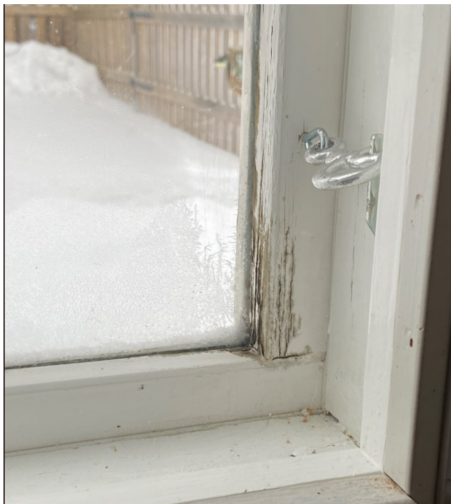
KUVA 24. Ikkunassa huurtumista ja kosteuden aiheuttamaa rappeutumista. (Huusko 2023)
