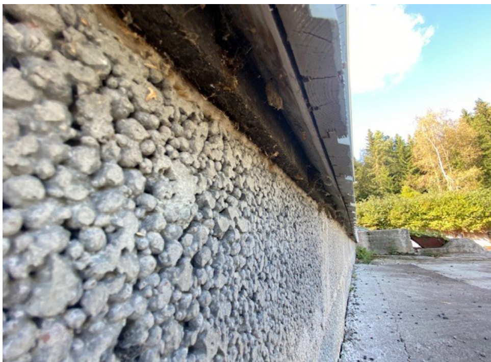
KUVA 22. Puutteellinen julkisivun tuuletus. (Huusko 2023)
