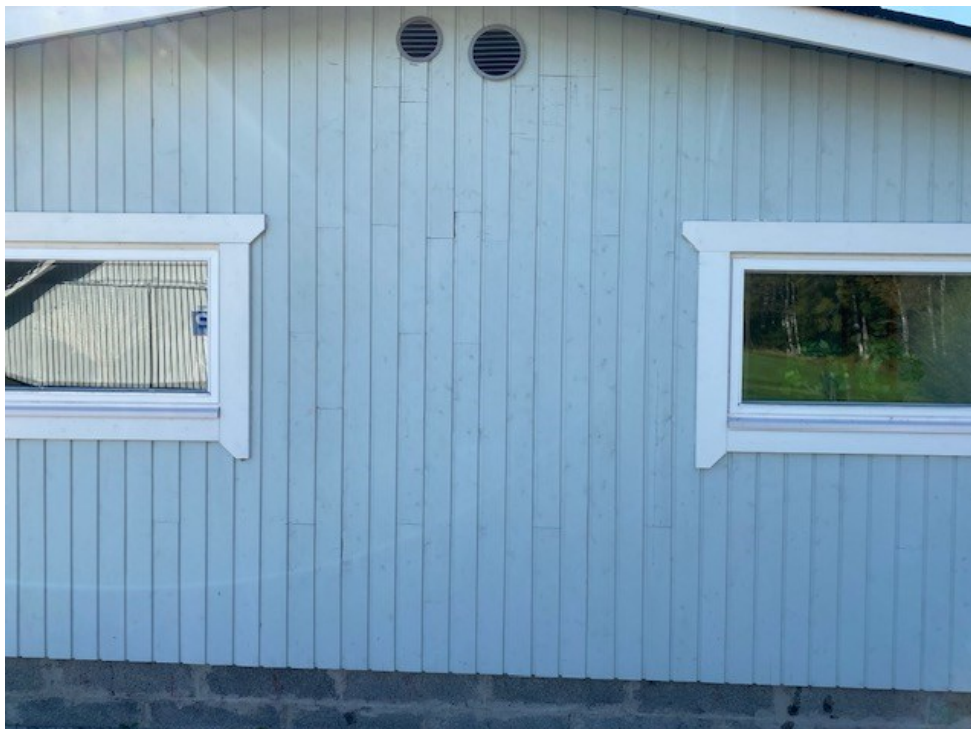
KUVA 21. Julkisivu verhouksessa saumoissa pientä irtoilua. (2023)
