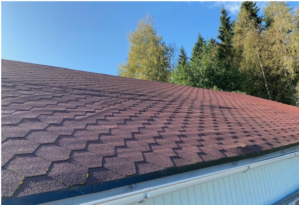
KUVA 28. Vesikatolla painaumia. (Huusko 2023)
