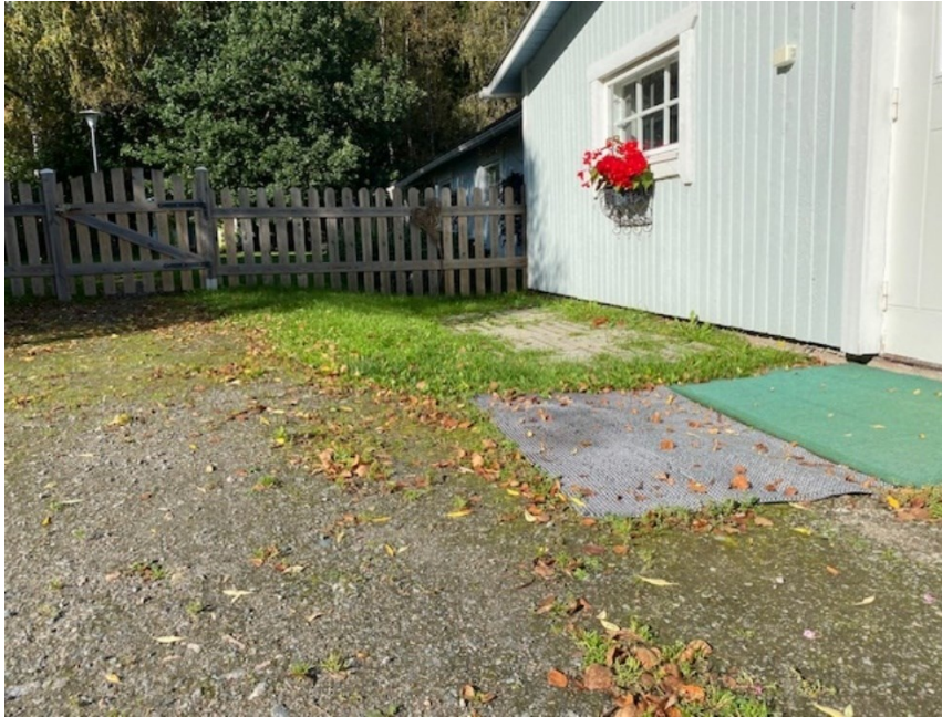
Kuva 4. Maanpinta kaataa rakennukseen päin. (Huusko 2023)
