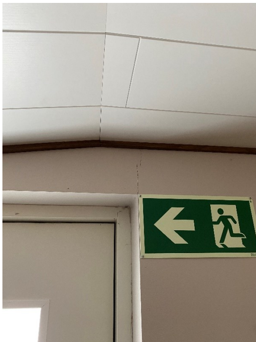
KUVA 32. Halkeama oven ylänurkassa (Huusko 2023)
