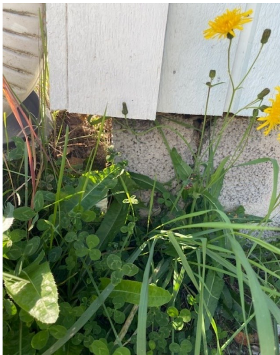
KUVA 9. Sokkelin halkeama. (Huusko 2023)
