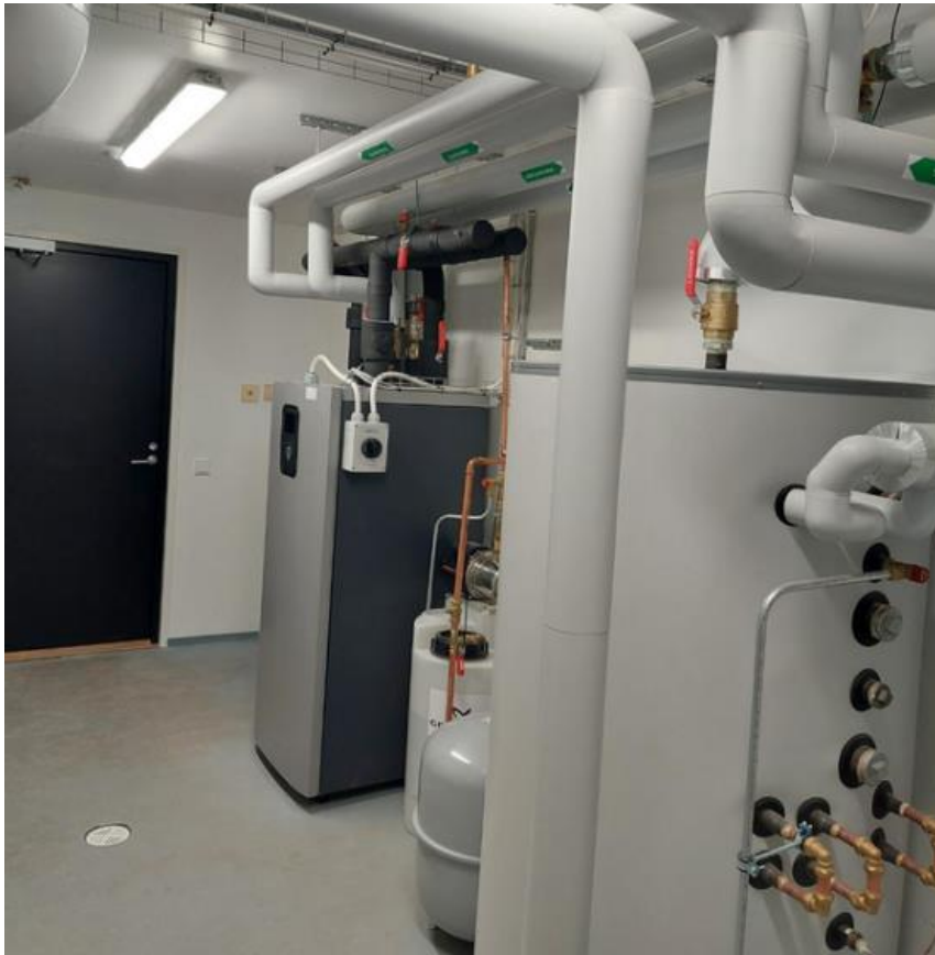
Kuva 18. Maalämpöpumpun, lämminvesivaraajan ja paisunta-astian sijoitus tekniseen tilaan.
