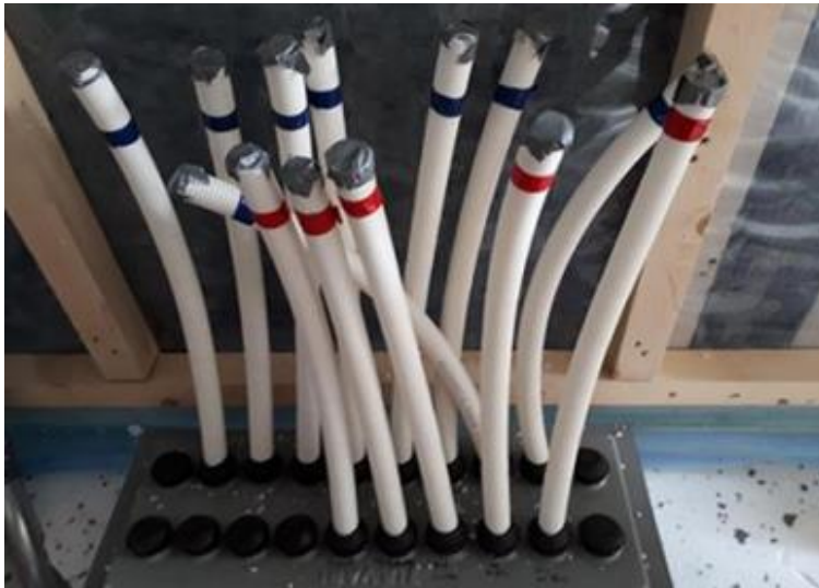
Kuva 12. Lämpimän ja kylmän käyttövesiputket merkittyinä ja tulpattuina.
