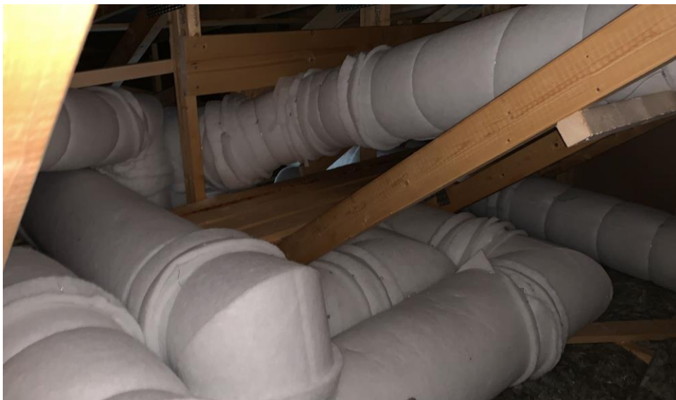
Kuva 15. Yläpohjassa lämmöneristetyt ilmanvaihtokanavat.
