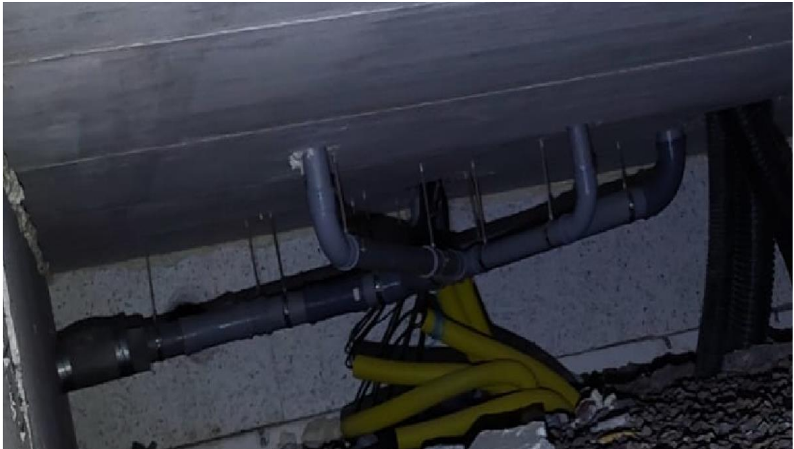
Kuva 7. Tuulettuvan alapohjan viemärit ja niiden kannatuksia.
