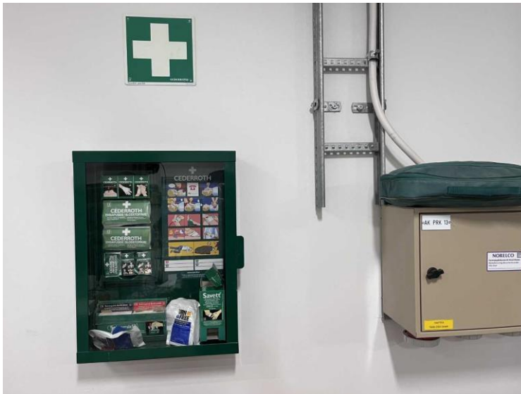
Kuva 4. Ensiaputarvikkeet rakennustekniikan laboratoriossa (Hussein Mustapha 2023)
