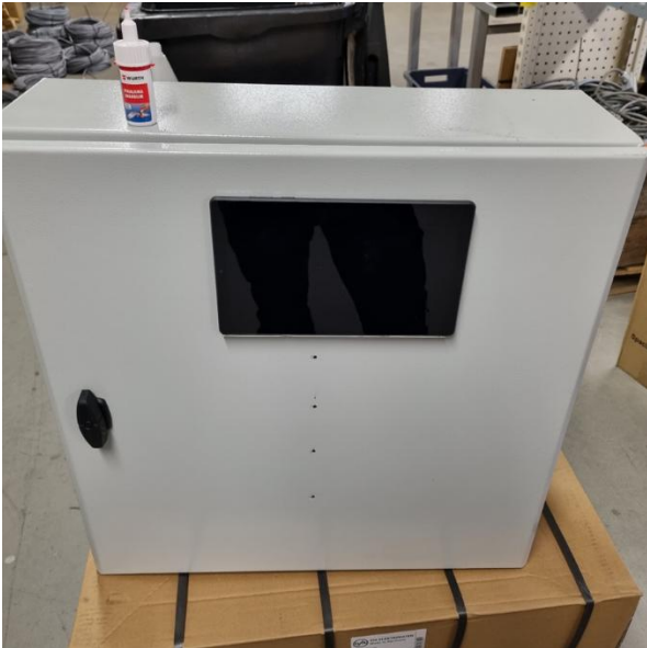
KUVA 11. Älylaite kiinnitettynä ohjauskeskukseen
