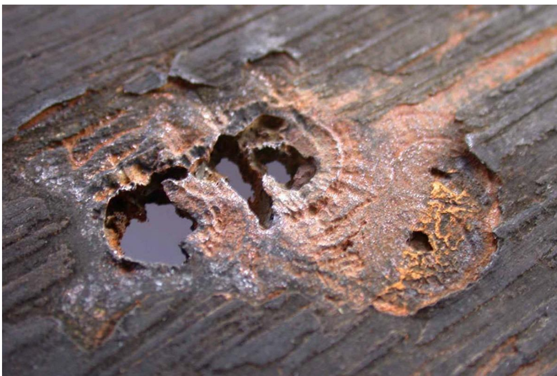
Kuva 3. Pistekorroosio. (Steel Fabrication Services, 2021)
