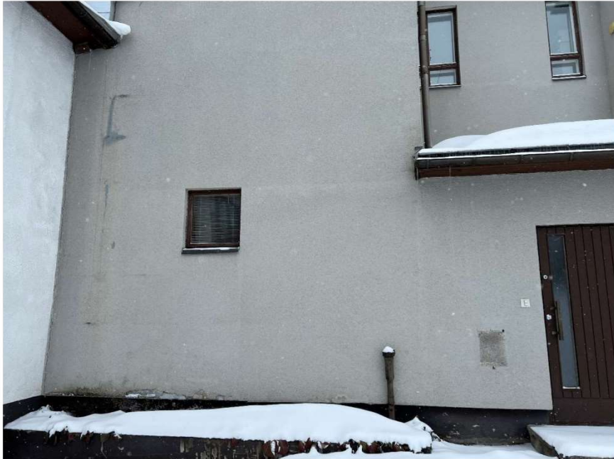
Kuva 2. Sisäpihalla rakennuksen sisänurkasta puuttuu syöksytörvi. Sadevedet kasteleht seiniän.
