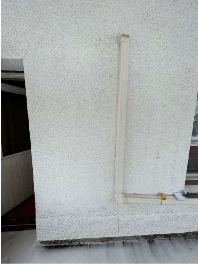
Kuva 3. Toisen kerroksen parveke. Rappauksessa halkeamia.
