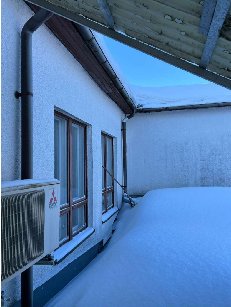
Kuva 4. Toisen kerroksen parvekkeelta. Kosteutta havaittavissa Rästään ja ulkoseinän rajassa. Yläosan rappauksessa havaittavissa kosteusjälkiä.
