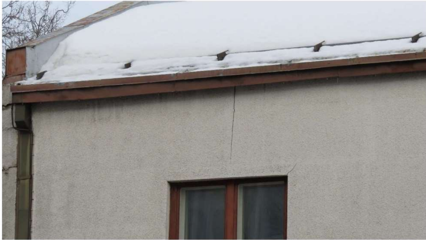
Kuva 5. Kadun puoleisen ikkunan ja räystäään välissä halkeama. Julkisivun rappauksessa kosteusjälkiä.
