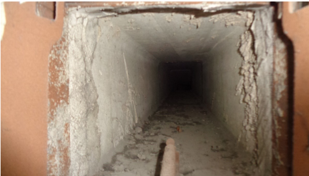
Kuvio 10. Asbestipitoinen IV-kanava (Vuonna 1964 rakennetun kerrostalon haitta-aine löydökset 2017.)
