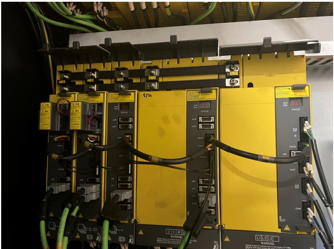
Kuva 13. Työstökoneen Fanuc -ohjausjärjestelmän akseleiden servovahvistimet, sekä DC-virtalähde.
