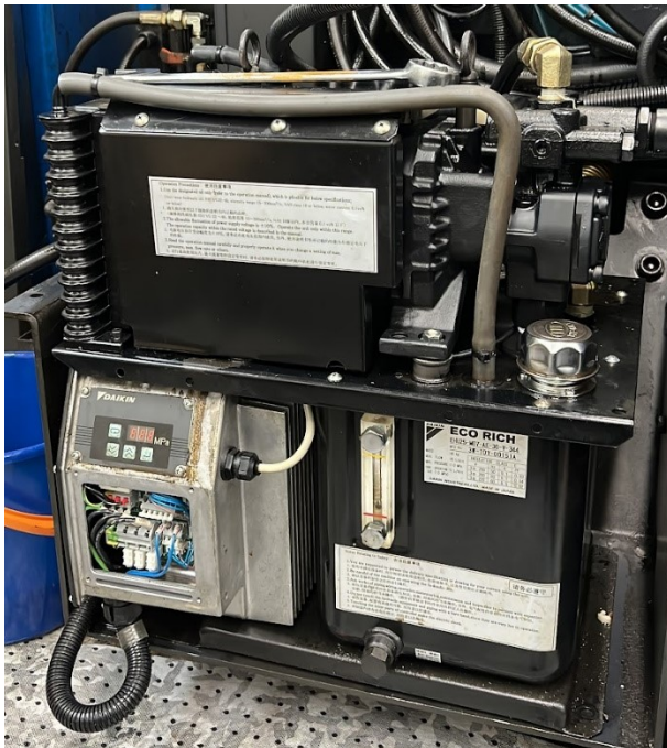
Kuva 10. Moderni taajuusmuuntajakäytöllä varustettu hydraulikkayksikkö.
