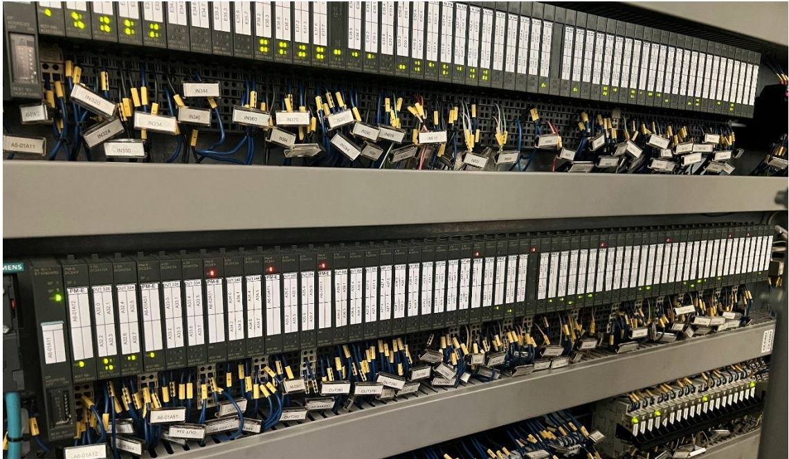
Kuva 14. Siemens ohjauksjärjestelmän Input ja Output moduulit.
