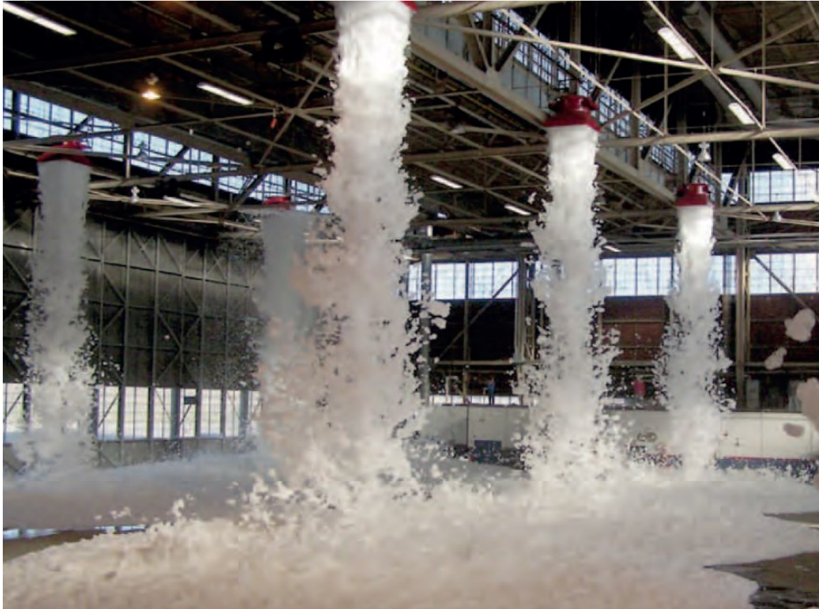
Figure 23. A foam fire suppression system in action. (Rakennustietosäätiö RTS, 2012, p. 10)
