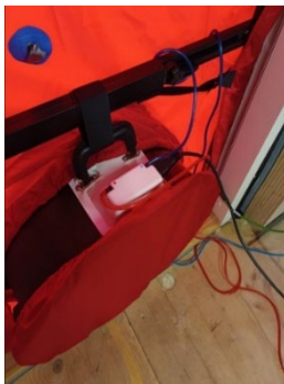
Kuva 46. Paine- nekoelaitteiston puhallin.
