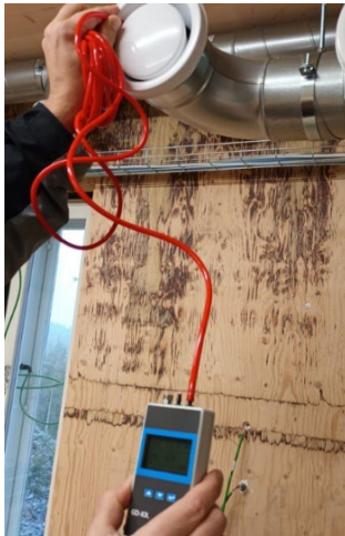
Kuva 51. Poistoilmaventtiili. Paine-eron mittaus GD- 10 L-laitteella.
