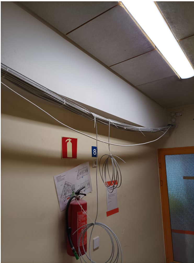
Kuva 4. Valvontakäynnillä todettu puutteellinen kaapeleiden kannatus. (Oma kuva, 2023)
