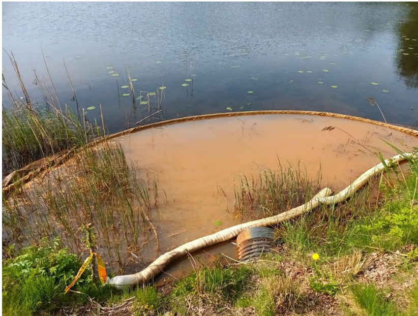
Kuva 9. Saimaanportin koulun rakennustyömaan hulevesiallas Urpolanlammessa 6.6.2023. Allas on eristetty muusta lammesta silttikankaan avulla. Kuvassa etualalla putken suulle asennettu öljypuomi. WaterPlus-hankkeen mittauksissa ja näytteenotoissa hulevesiallas oli nimellä piste 4 (kuva Aki Mykkänen).
