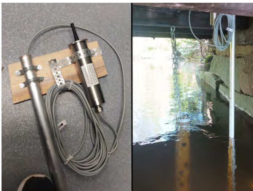
Kuva 5. Vasemmalla Keller ADT-1 -lähetin sekä alumiiniputki, jonka sisälle Keller 36X pinnankorkeusanturi asennettiin. Oikealla mittarikokonaisuus asennettuna Urpolan luontokeskuksen läheisen sillan alapuolelle jatkuvatoimisen YSI EXO -vedenlaatusondin viereen. Putki ylettyy uoman pohjaan saakka. (Kuva Aki Mykkänen)
