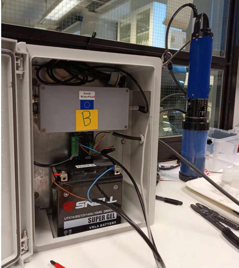
Kuva 2. Valmis vedenlaadun mittausasema. Kuvassa kytkentäkotelon sisällä ylipänä harmaa Keller ARC-1-lähetin sekä antenni. Lähettimen alapuolella on SOA-signaalinmuunnin, johon kytkennät akun, mittarin sekä lähettimen välillä tehtiin. Alimpana kaikissa asemissa käytetyt 12 voltin geeliakut. (Kuva Aki Mykkänen)
