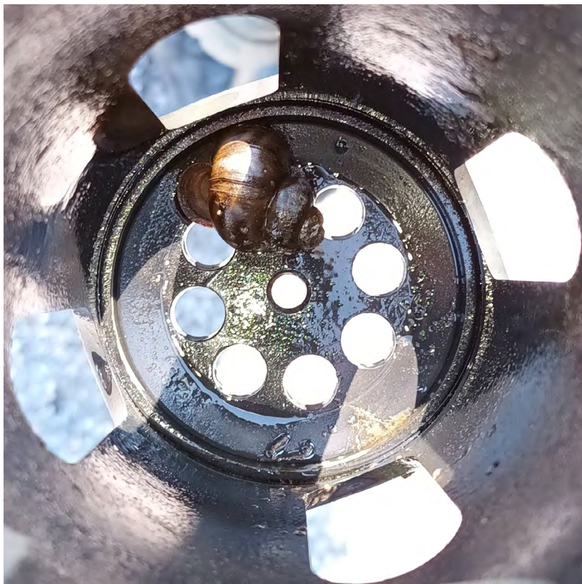
Kuva 11. Aseman D sensorisuojan sisälle muuttanut kotilo, joka häytti sameusmittauksia noin viikon ajan ennen kuin asemaa pystyttiin käymään huoltamassa ja kotilo häätämässä (kuva Aki Mykkänen).
