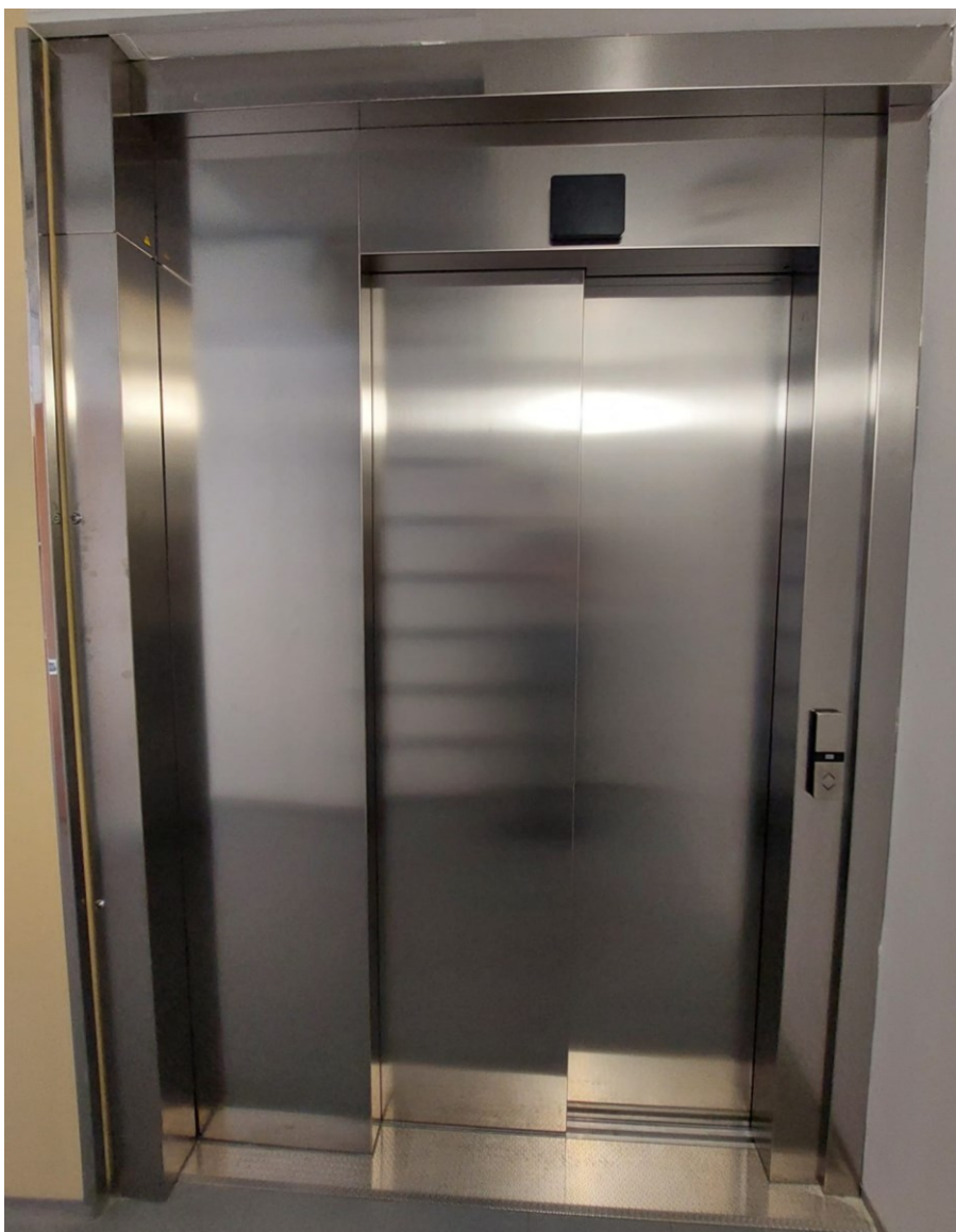
Kuva 7. Konehuoneeton hissi, jossa hissien ohjauskeskus on sijoitettu kuvassa kuilun oviaukon ja ovien vasemmalle puolelle.
