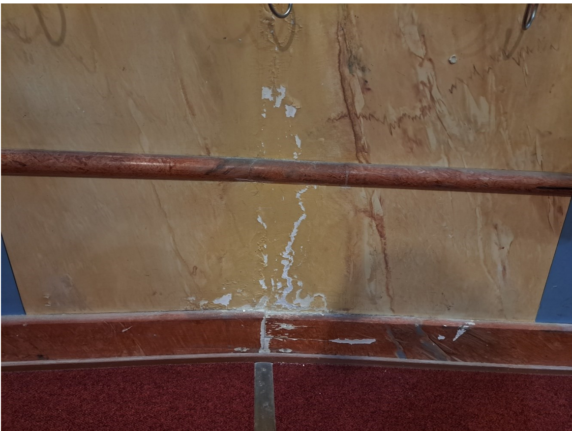
Kuva 16. Maali rapistunut betoniseinällä
