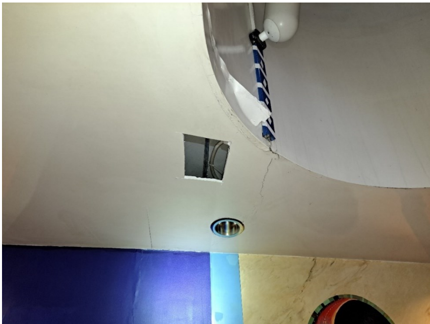
Kuva 19. Katon kipsilevysaumat halkeilleet valokaivon lähetyvillä
