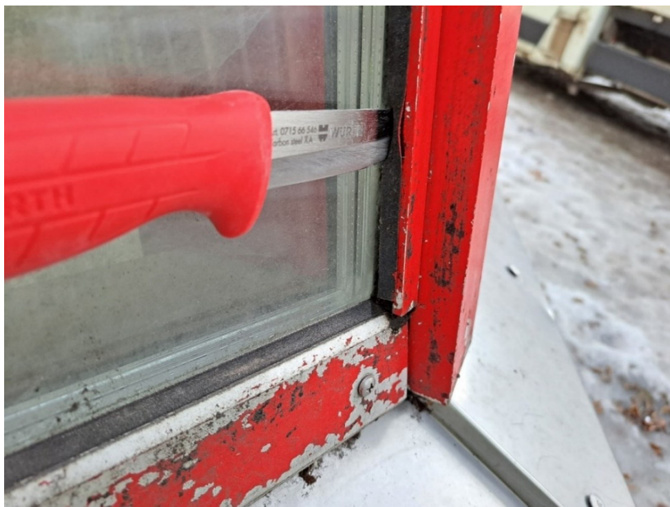
Kuva 22. Valokaivoon tulee vaihtaa uudet ikkunat, sekä ne tulee tiivistää huolellisesti
