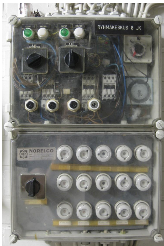
KUVA 4. Jäähdytyslaittekeskus (Valokuva Ville Roininen.)
