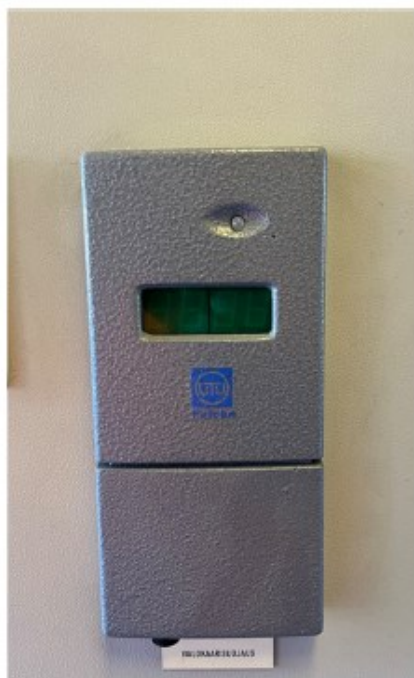
Kuva 8. Valokaarisuojaus ei toimi.
