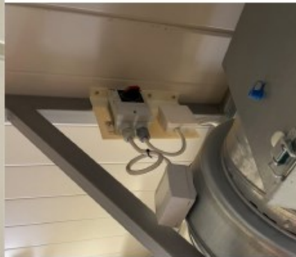
Kuva 4. Tuloilmapuhallin pois päältä.
