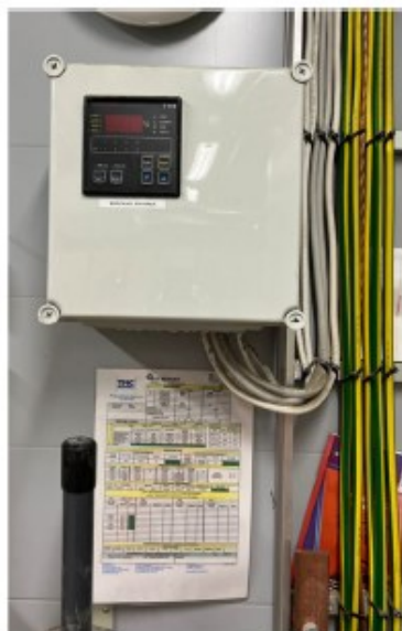
Kuva 9. Muuntajan lämpötilan valvontayksikkö.
