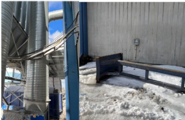
Kuva 21. Kaapelihylly vaurioitunut. Kuva 22. Autolämmityspistorasian kotelo.
