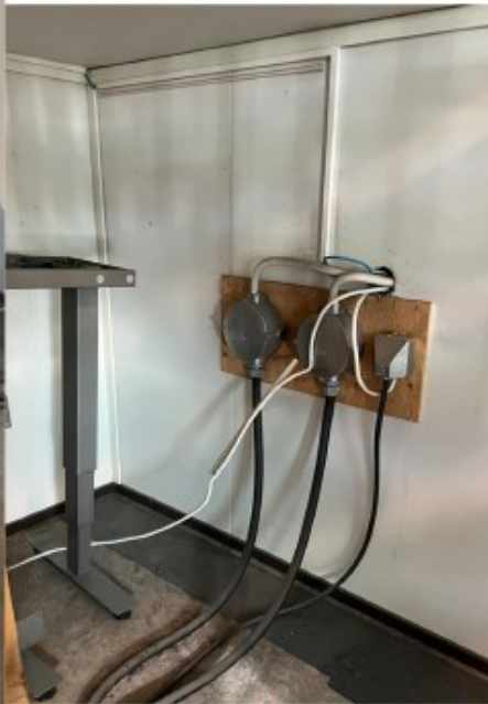
Kuva 6. Ulkopistorasian syöttö kiinnittämättä.
