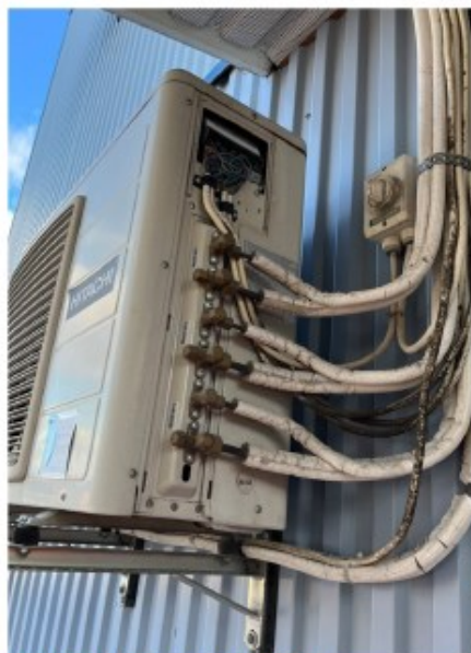
Kuva 23. ILP sähkökytkentäkotelon kansi puuttuu.
