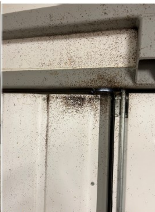
Kuva 2. Ilmanvaihto ei toimi oikein muuntamotilassa.
