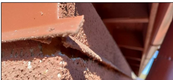
Kuva 26. Räystäspellin ja rappauksen väli avoin, villa näkyy.
