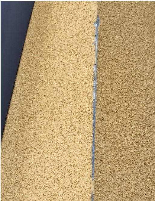
Kuva 26. Kohde 3, ulkokulman hiertymä
