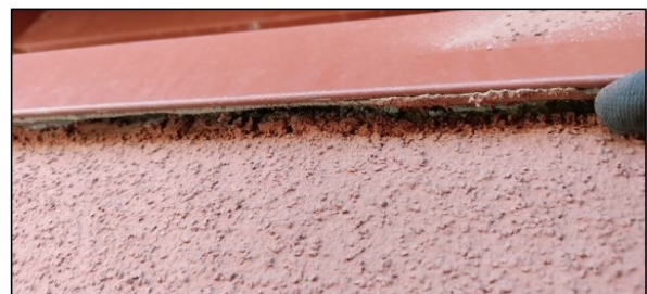
Kuva 27. Räystäspellin ja rappauksen alla mahdollisesti suora reitti eristetilaan.
