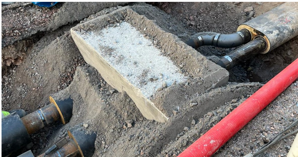
Kuva: Muovisuojakuorijohto (Mpul) ja valettu 2Mpuk kiintopiste-elementti
