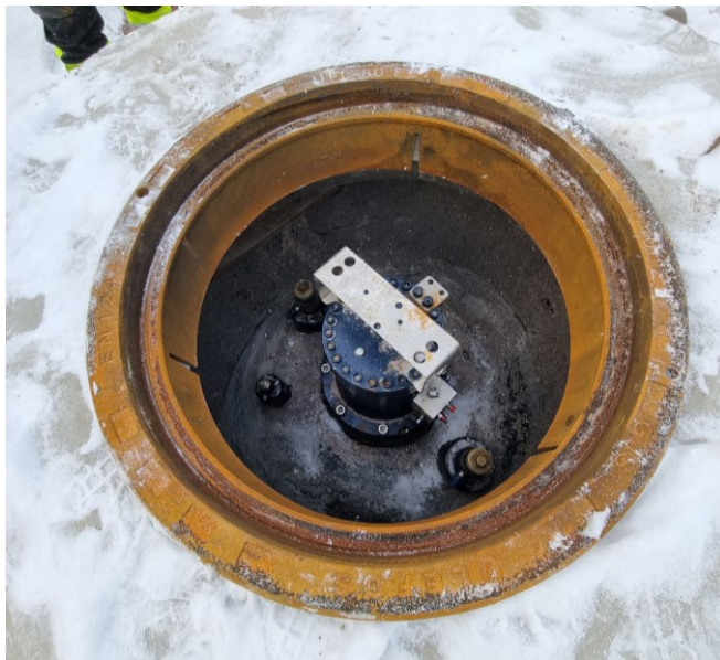
Kuva: Venttiili maaventtiilikaivossa
