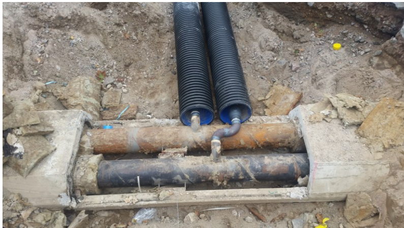
Kuva: 2Mpuk-haaroitus betonikanavaputkesta
