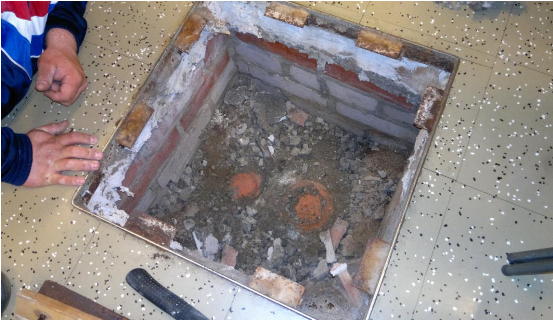
KUVA 3. Viemärin tarkistusluukku ennen korjausta
