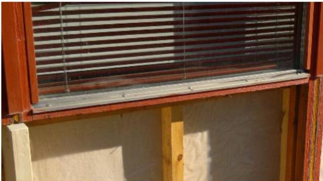
Kuva 4. Tippalistan sauma huonosti tiivistetty
