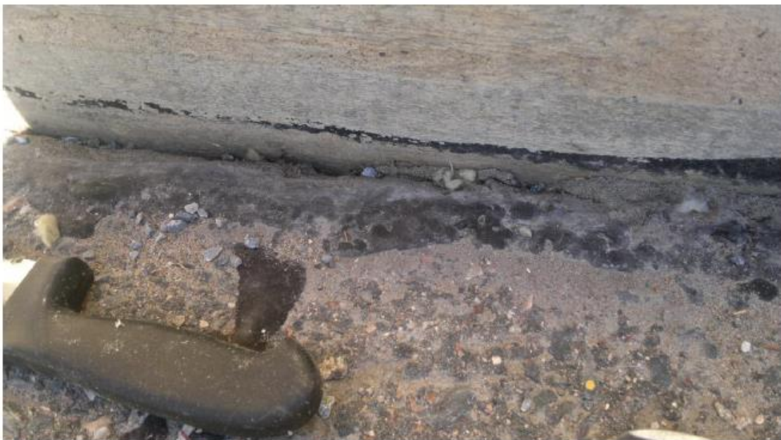
Kuva 2. Seinän vierestä bitumi on kulunut
