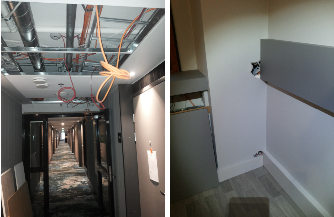
Kuva 10. Vasemmalla on hotellin käytävä, oikealla asuinhuone ja listojen vieressä rikko seinässä.
