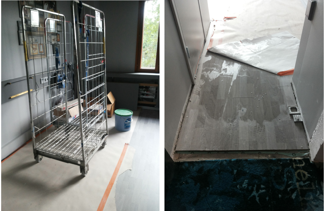
Kuva 11. Vasemmalla lattiassa suojaus paikoillaan, oikealla vaurio suojauksen alla
