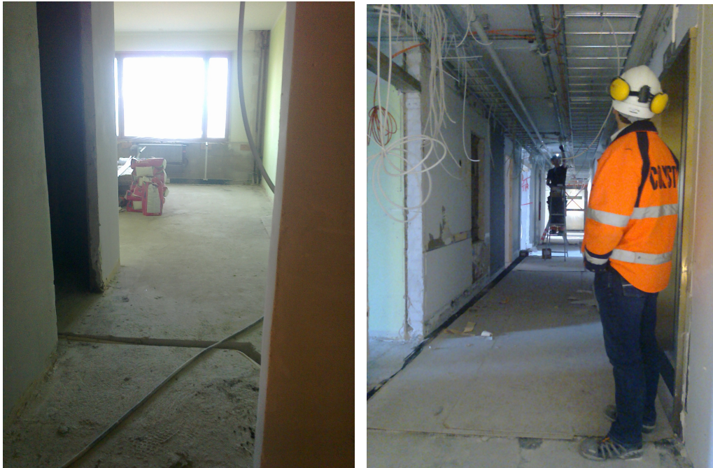
Kuva 4. Vasemmalla on hotellin asuinhuone, jossa purkutöitä on tehty. Oikealla on työnjohtaja hotellin A-siiven käytävällä valvomassa pintakäsittelytyötä maaliskuussa 2014.
