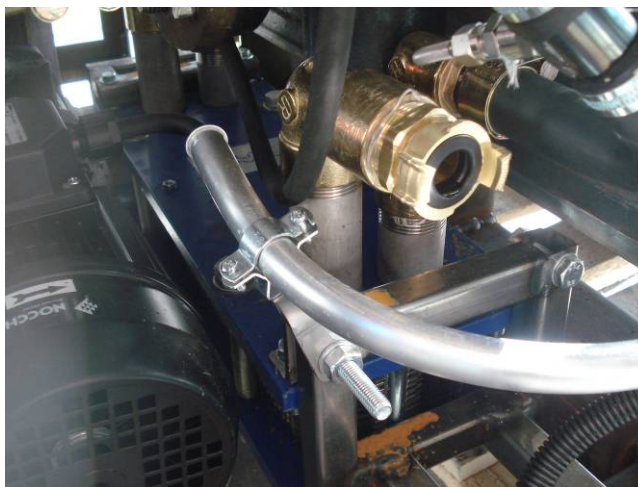
Kuva 24 Jäähdytysveden sisäänmenoliitin 1. lämmönvaihtimessa
