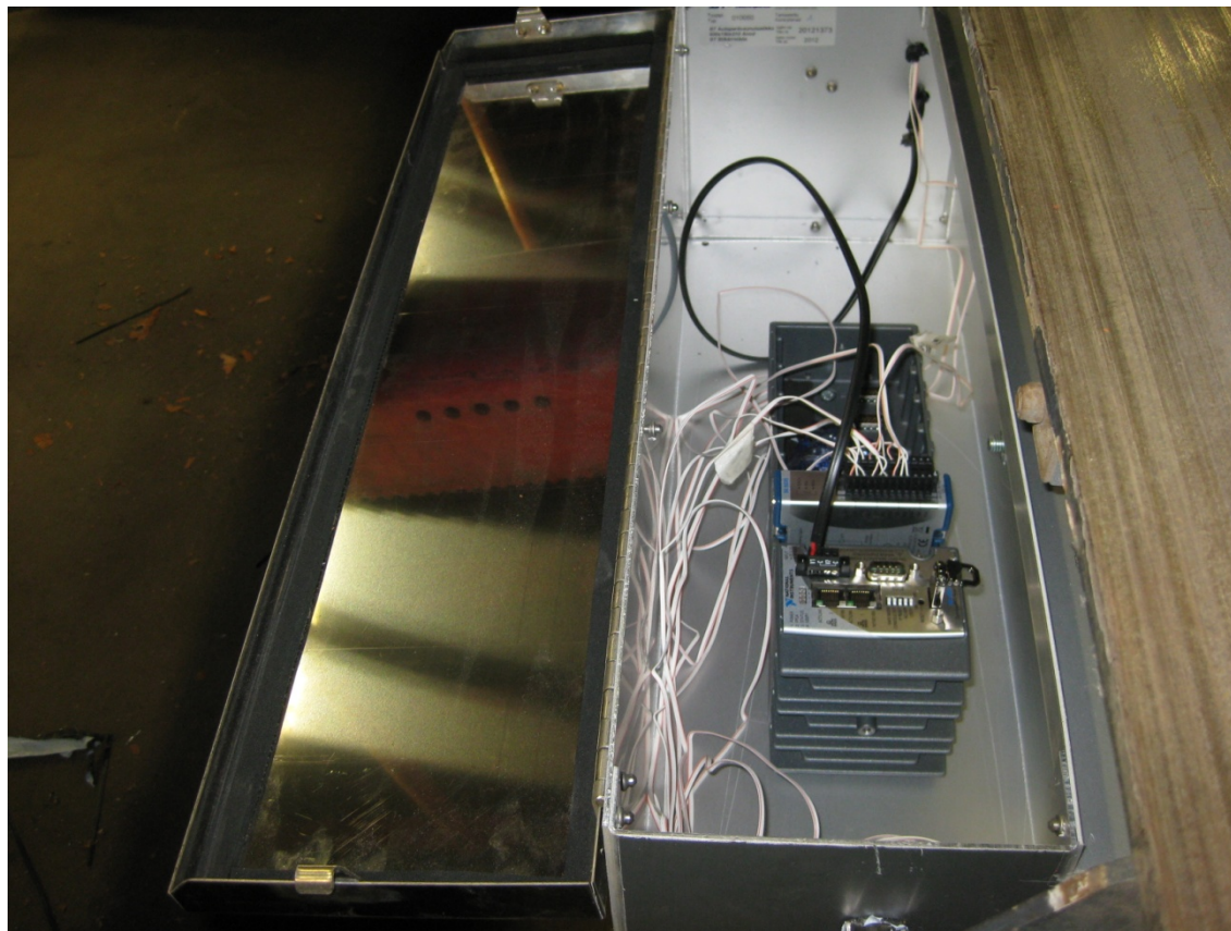
KUVA 23. Mittalaite asennettuna paikoilleen johdotukset kytkettyinä ja johtojen läpiviennit tiivistettyinä (Kuva: Kalle Seppälä 2014)
