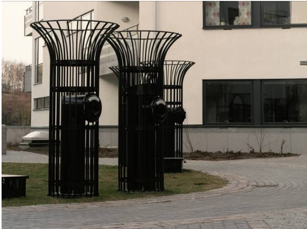
Kuva 55 Jätehuolto voi olla myös tyylikästä. Automaattisen jätteenkeruujärjestelmän suuaukot herättävät huomiota tyylikkyydellään /15/.
