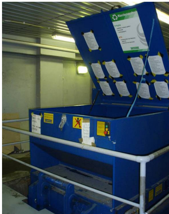
Kuva 27 Hammareninkatu 2 jätepuristimen luona on niin paljon ohjeita, etteivät käyttäjät todennäköisesti jaksakaan niitä lukea. Kaiteet parantavat turvallisuutta.
