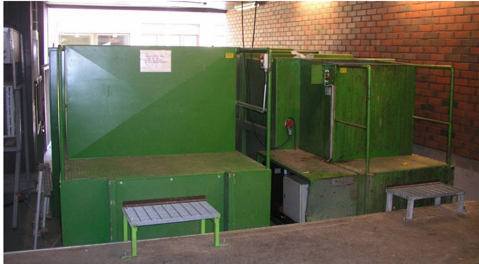
Kuva 40 Sumeliuksenkatu 18:n jätepuristimiin laitetaan jätteet lastaussillalta. Parimmat kaiteet estäisivät puristimen käyttäjän horjahtamisen lastaussillan ja puristimen väliin.
