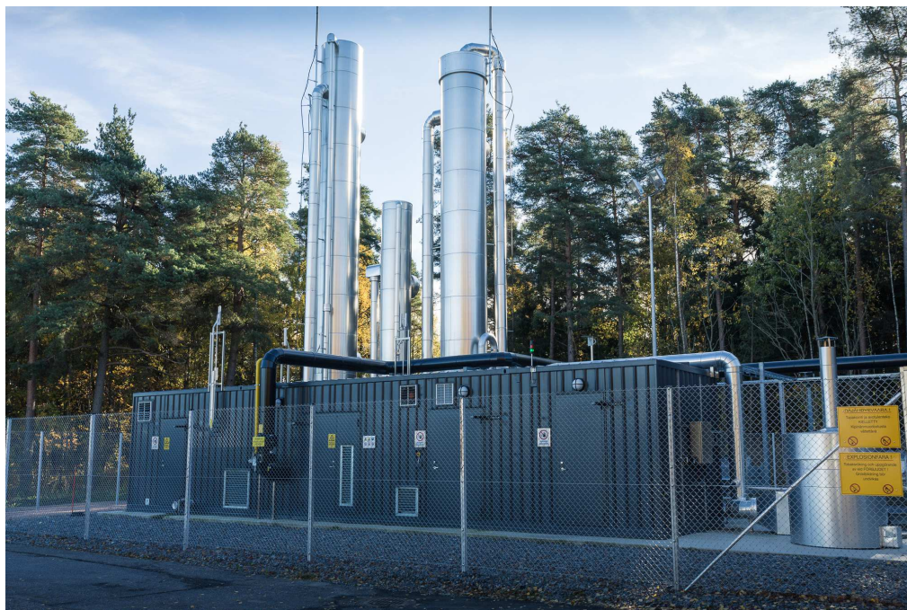
Kuva 1 Suomenojan vesipesutekniikkaan perustuva kaasun puhdistusyksikkö (Gasum).
