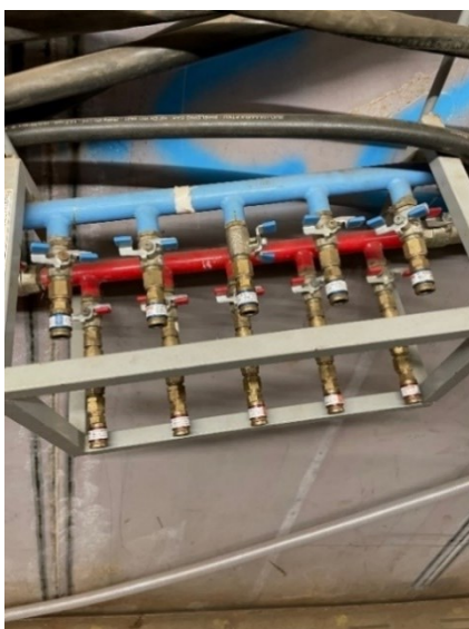
Kuva 14. Kaasun jakotukki laivassa. Tarkistetaan, että hanat ovat kiinni, jos ei kaasua käytetä.
