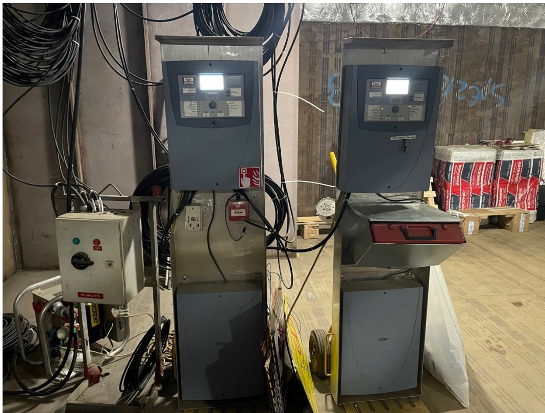
Kuva 25. Laivan rakentamisen aikainen paloilmittin
