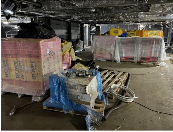
Kuva 8. Ei suojausta lainkaan
