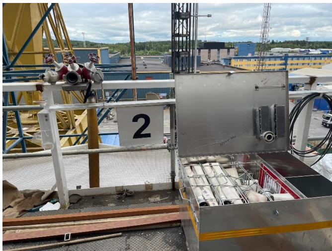
Kuva 17. Palovesilinja ja letkulaatikko
