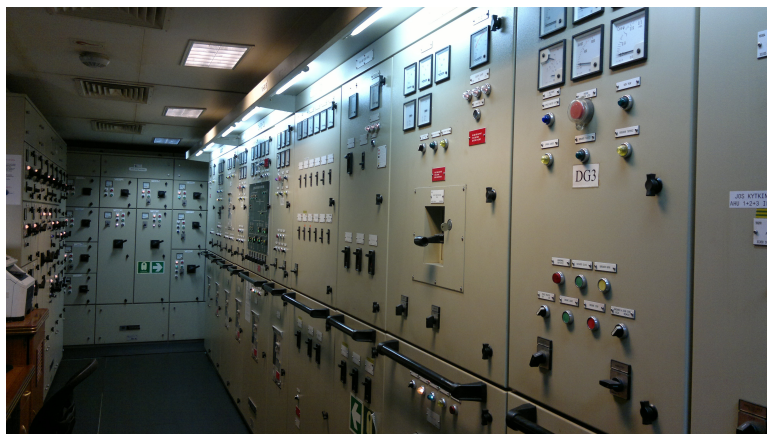
Kuva 7. Päätaulu MS1 sekä MCC1 ja MCC2. (Ossi Sjöberg, 2014)
