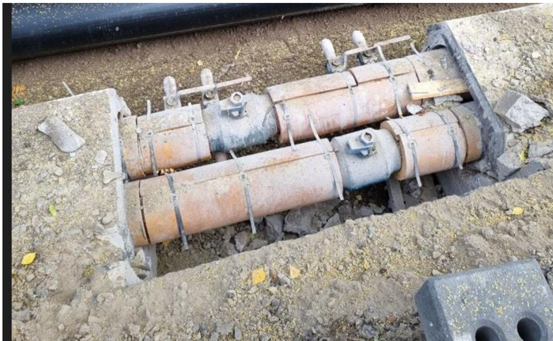
KUVA 8. DN 150 EMV, Betonielementtikanava (Vuori 2022)
