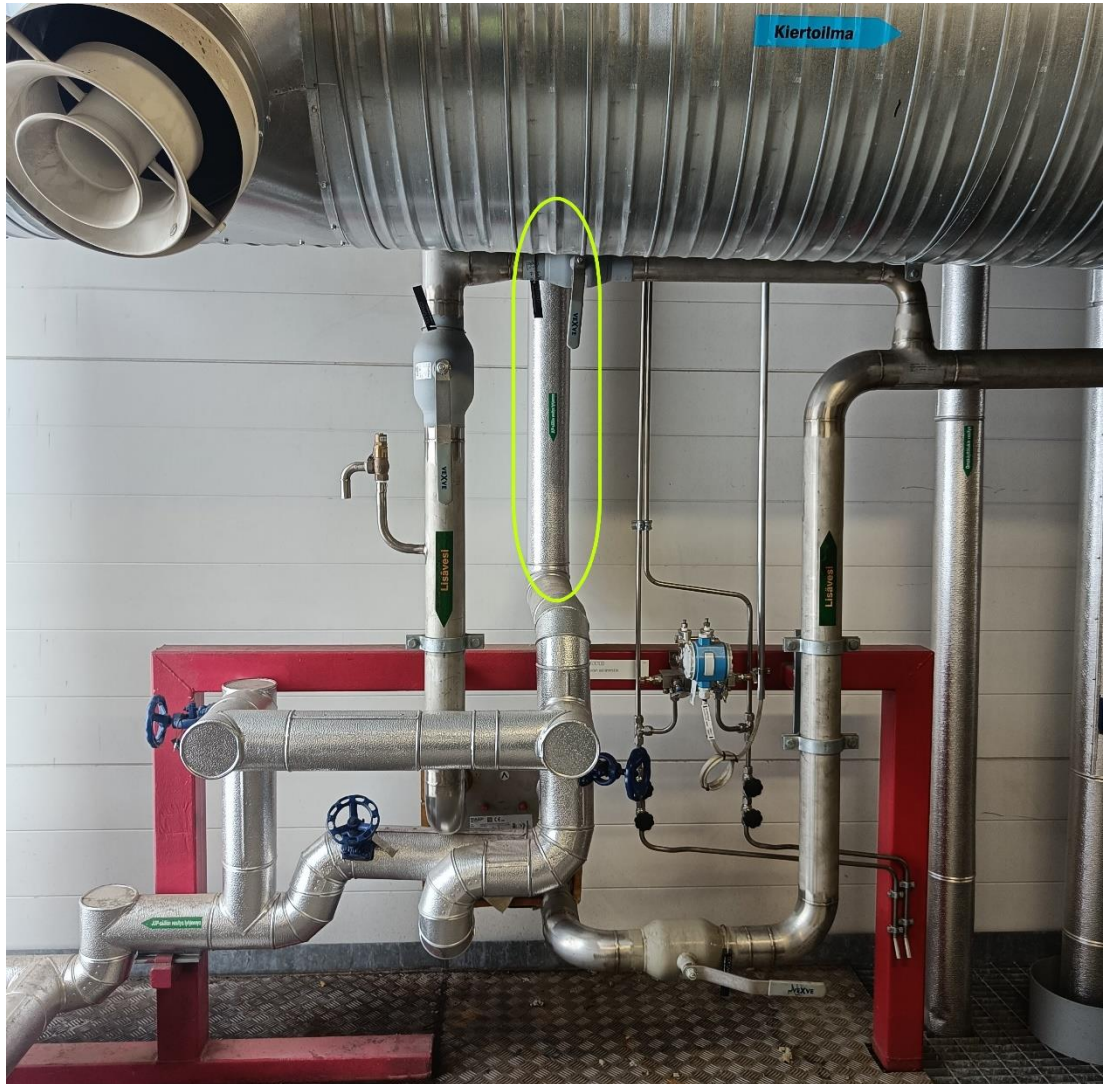
Kuva 10. Lämmönsiirtimeen tuleva lämmityksen tuloputki JUP-säiliöstä.
